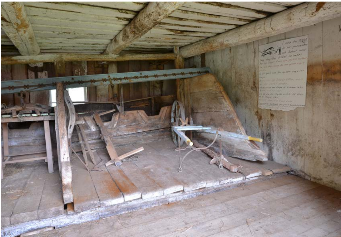
Bild 6. Oxstallets bås och panelade vägg innan åtgärder. Hussvampssporerna kan ses på både det övre och undre plankgolvet. Foto 2021-10-25. SLM D2023-0004.
