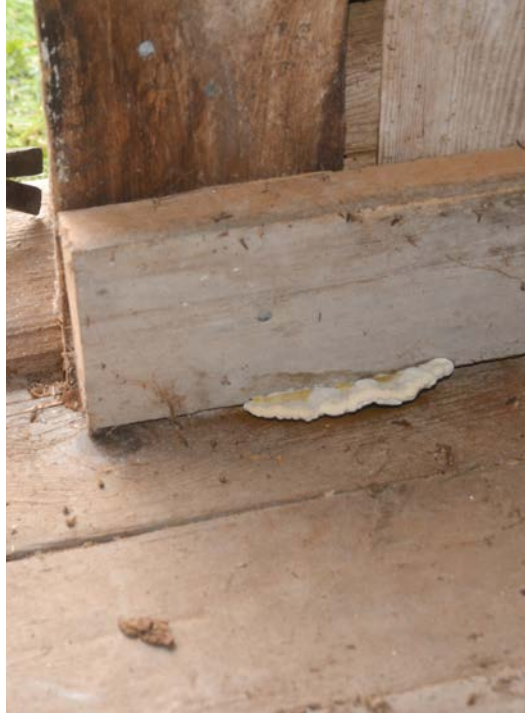
Bild 9. Svampkropp bakom golvlisten till höger (öster) om ingången. Foto 2021-10-07. SLM D2023-0007.
