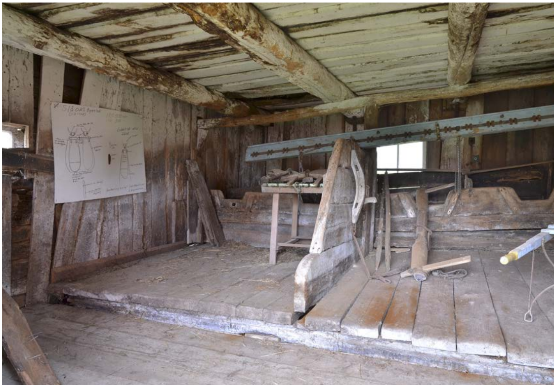
Bild 5. Oxstallets bås och östra gavelvägg innan åtgärder. Hussvampssporerna kan ses på både det övre och undre plankgolvet. Foto 2021-10-25. SLM D2023-0003.
