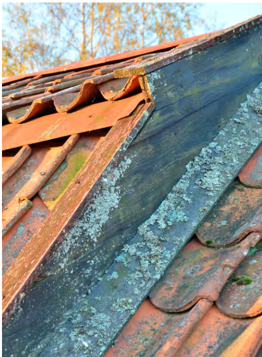
Bild 7. Panelklätt gavelröste mellan garvarebostaden och torkladan, innan renovering. Foto 2021-10-25. SLM D2022-0162.
