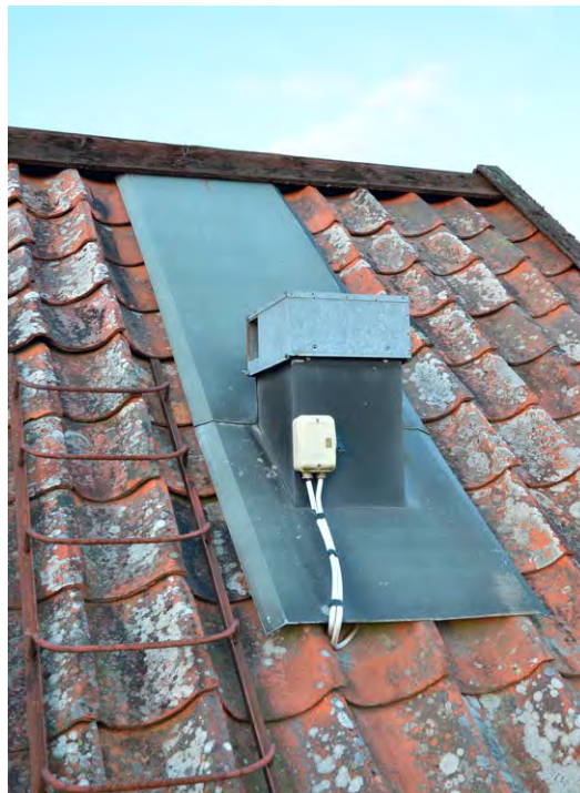
Bild 8. Otidsenlig ventilhuv på torkladans östra takfall. Foto 2021-10-25. SLM D2022-0163.
