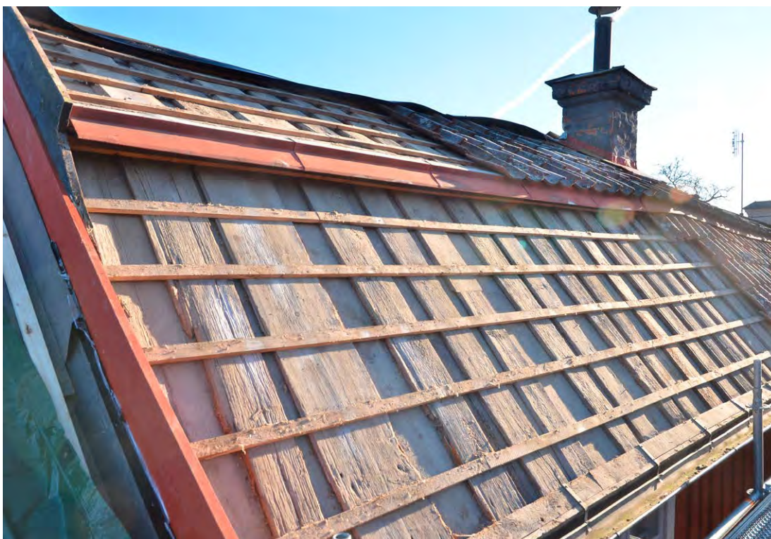
Bild 17. Äldre underlagstak på garvarebostadens västra takfall. Notera plåten i takfallets brytning, som togs bort och ersattes med ny falsad plåt. Foto 2022-01-25. SLM D2022-0172.
