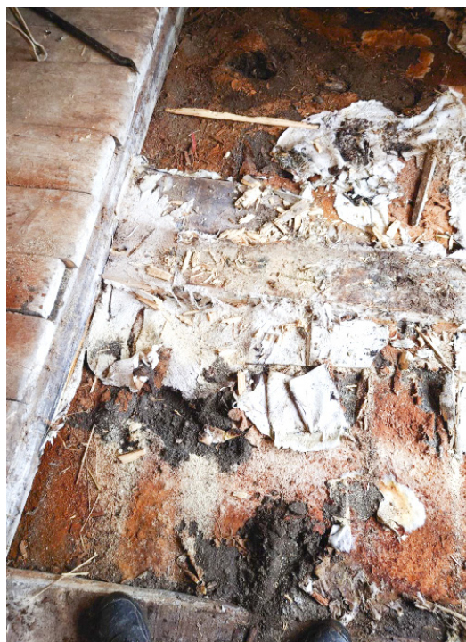
Bild 7. Svampkroppar under de utrivna golvbräderna. Foto 2021-11-03 av Jon Åhlund. SLM D2021-0704.
