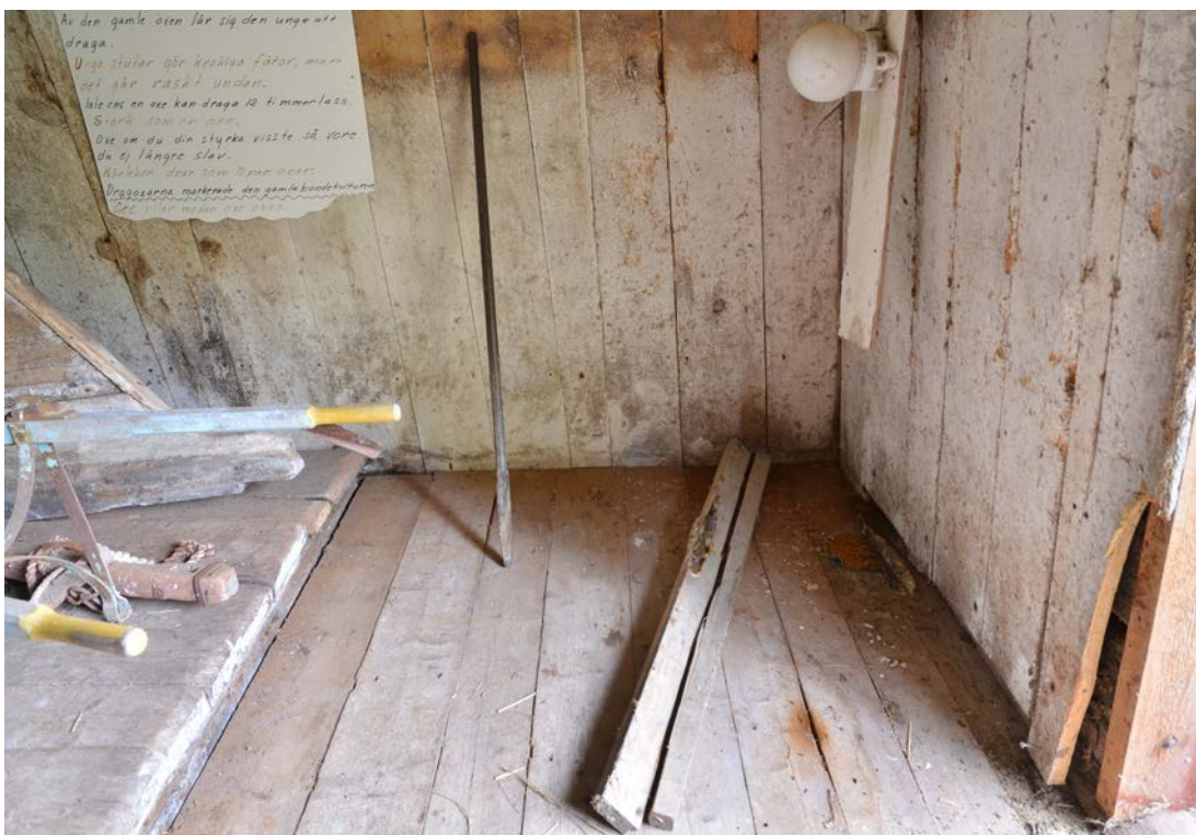
Bild 22. Oxstallets främre del, vy mot väster. Notera de rödbruna hussvampssporerna mellan golvbrädorna, samt hussvampskroppen i mitten av den skuggade golvytan. SLM D2021-0619.
