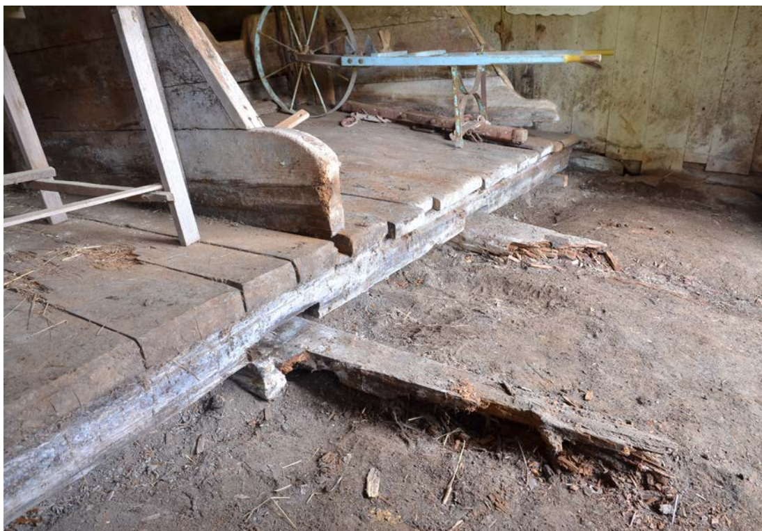
Bild 31. Rött skadat bjälklag under det främre brädgolvet. SLM D2021-0626.
