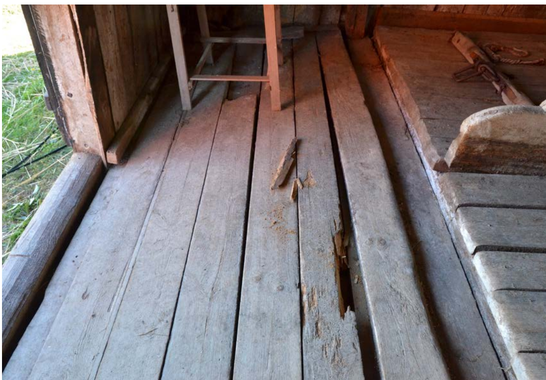
Bild 27. Brädgolvet som det såg ut fram till 2018. De rötskadade brädorna byttes ut till annat äldre virke. Eva Wockatz, 2018-09-03. SLM D2021-0642.
