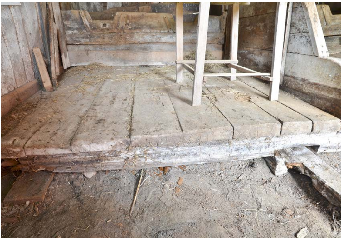
Bild 30. Brädgolvet i båset till vänster från ingången. Bilden är tagen efter att de främre brädgolvet lyfts bort och svampkropparna inklusive översta jordlagret schaktats ut. SLM D2021-0625.
