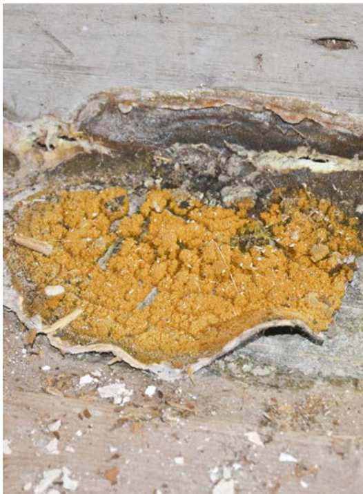
Bild 4. En av de större synliga svampkropparna (ca 20 cm i diameter) ovanpå brädgolvet vid oxstallets nordvästra hörn. SLM D2021-0615.
