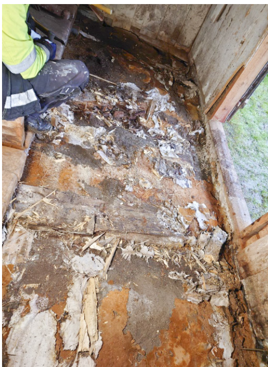
Bild 6. Svampkroppar under de utrivna golvbräderna. Foto 2021-11-03 av Jon Åhlund. SLM D2021-0703.
