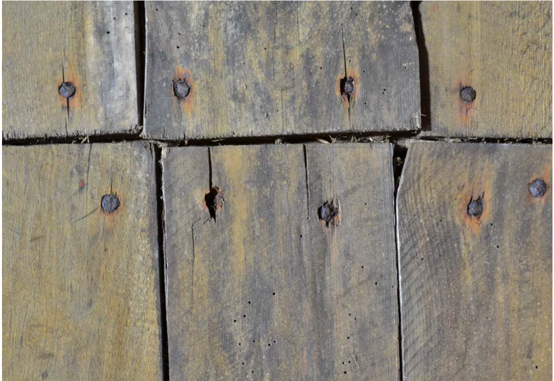
Bild 19. Rostiga spikar i underlagstaket, bottenvåningens sydöstra del. SLM D2021-0282.
