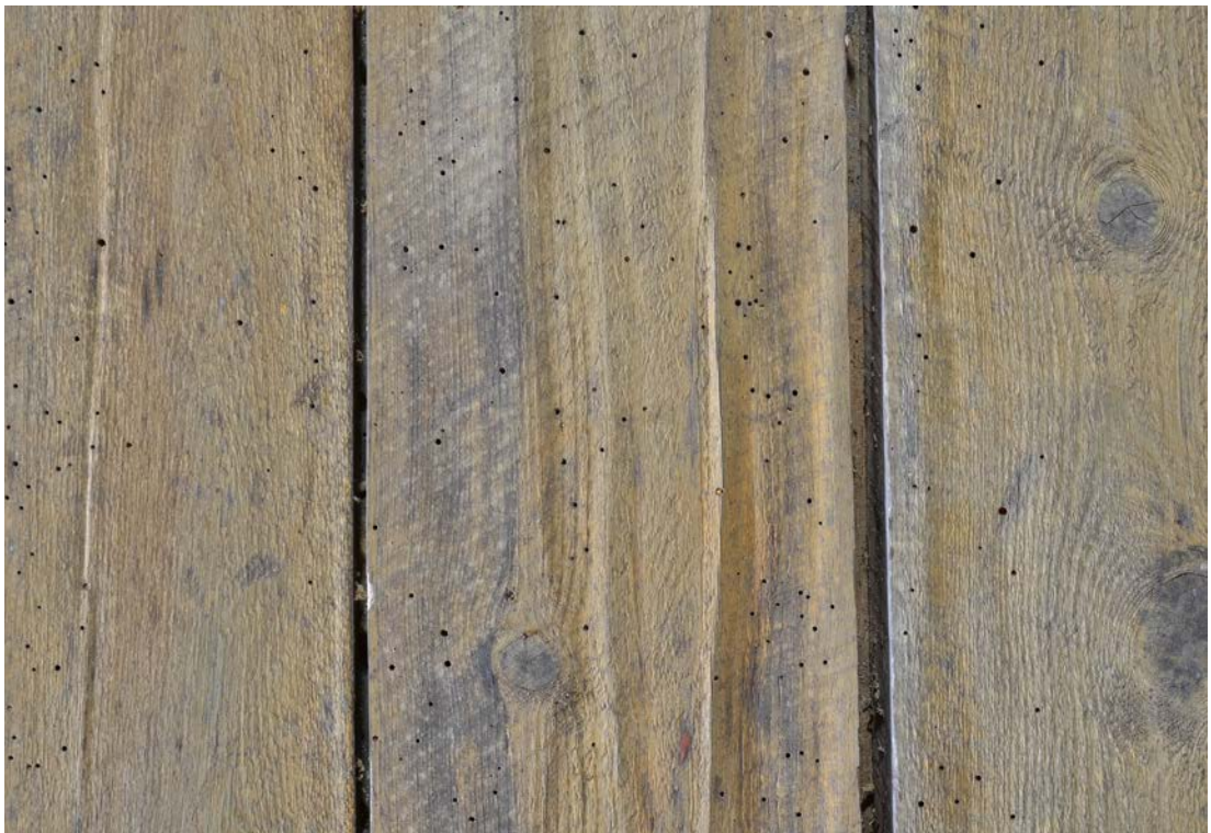
Bild 20. Bräddtaket i bottenvåningens sydöstra del har både spår av strimmig trägnagare och ett något "bubbligt" ytskikt, som känns mjukt när man trycker på det. SLM D2021-0283.
