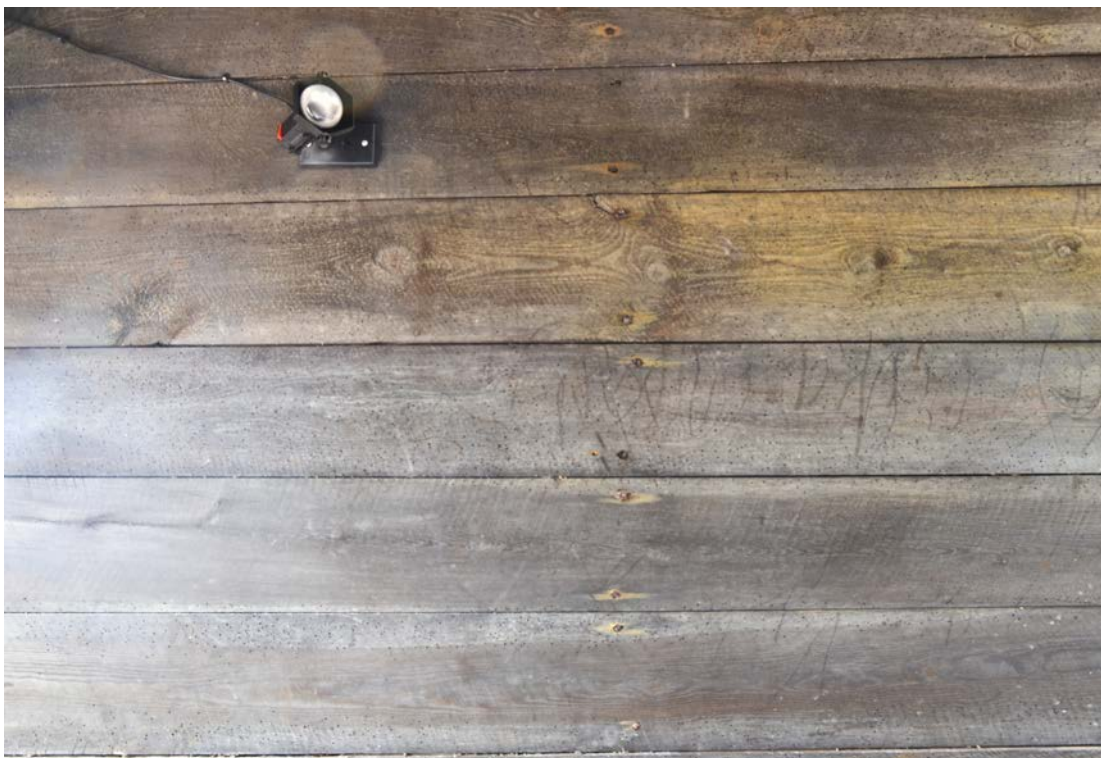
Bild 9. Taket intill norra gavelns fönster. Takbrädorna har synliga spår av strimmig trägnagare, samt svarta streck som liknar handskrivet klotter. Spikarna är mycket rostiga. SLM D2021-0272.
