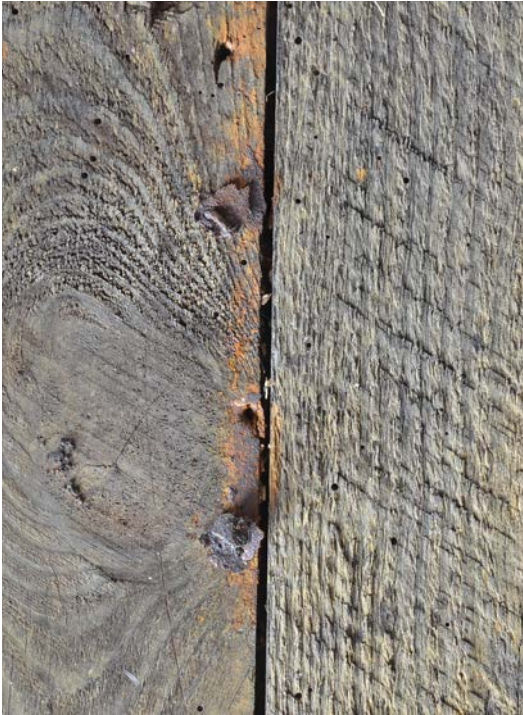
Bild 10. Rostiga spikar i taket i bottenvåningens norra del. SLM D2021-0273.
