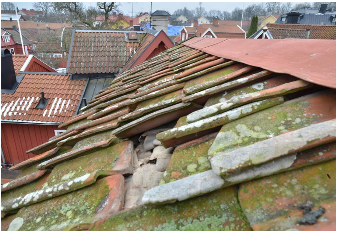
Bild 13. Garvarebostadens östra takfall. Notera de trasiga bitarna av björknäver under tegelpannorna. SLM D2021-0251.
