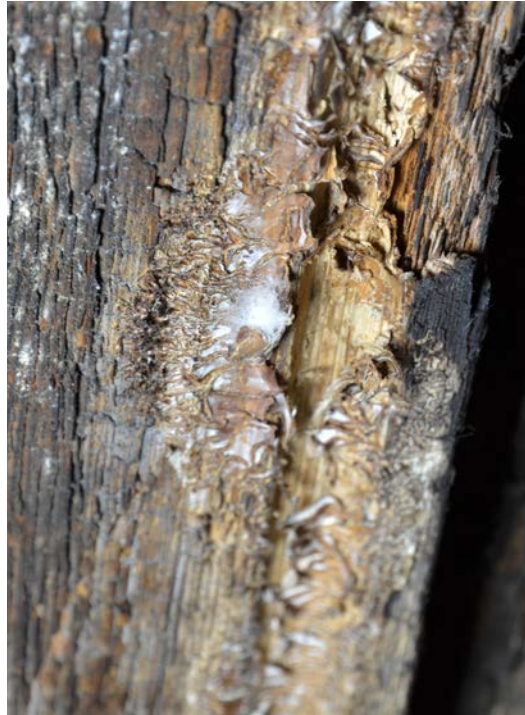
Bild 17. Närbild på en av de äldre brädorna med mjuk yta och synligt vitt mögel. SLM D2021-0255.
