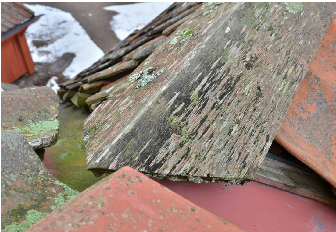
Bild 20. Nockbrädorna och några av vindskivorna ser ut att vara murkna. SLM D2021-0258.
