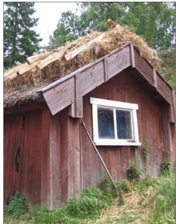
16 Marknivån är fortfarande för hög runt flera byggnader. Här syns hönshuset (Slm D11-792).
