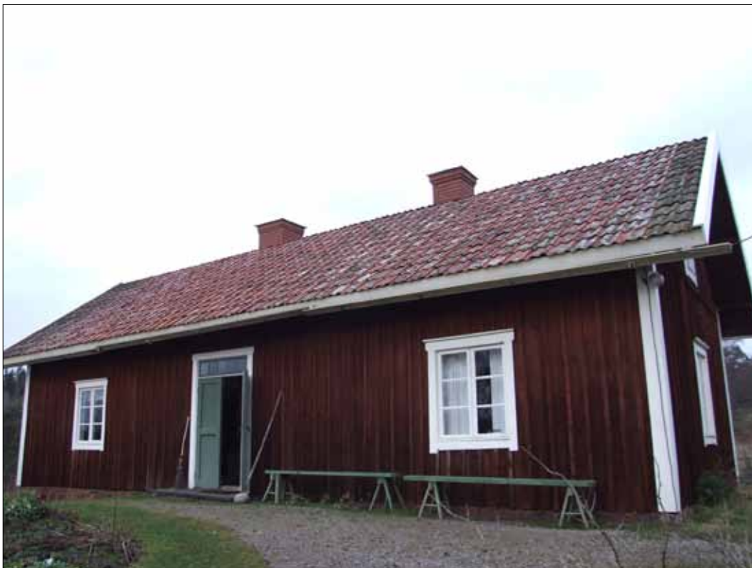
9 Bostadshuset sett från söder efter takomläggningen. En provisorisk hängränna har satts upp (Slm D11-785).
