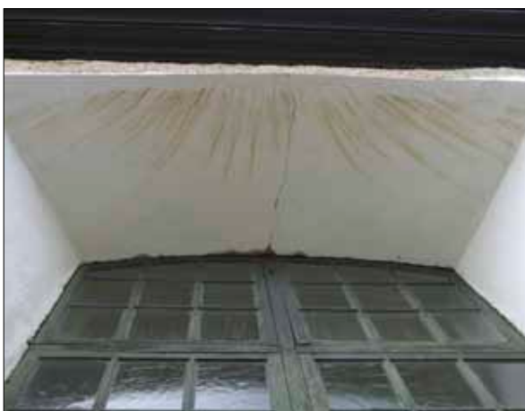
10 Flera av fönsternischerna hade rinningar och sprickbildningar i fönsterbågen. (D10-850)
