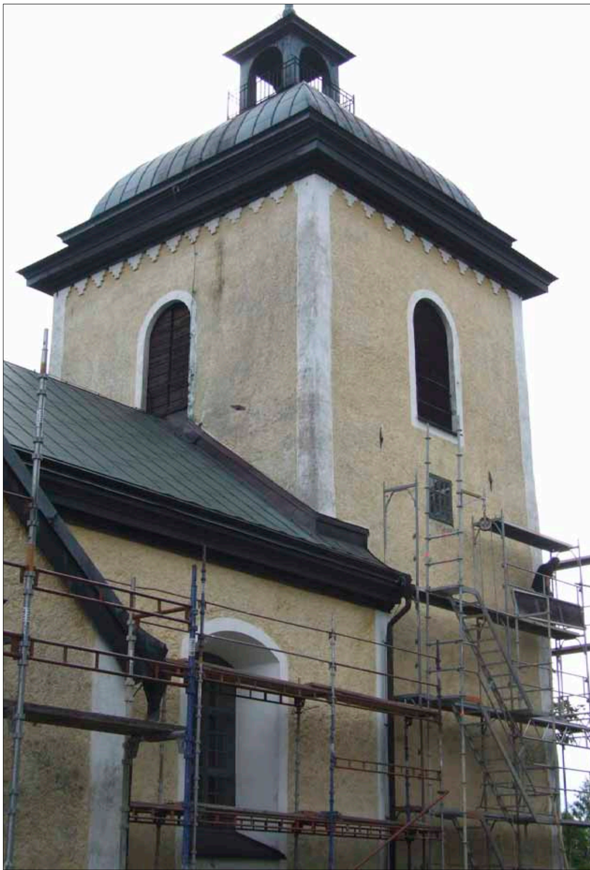
13 Tornet från nordost före arbeten. Skador förekom bland annat i anslutning till plåtkanten på tornets östra fasad. (D10-852)
