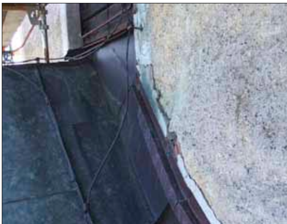
9 Skada på putsen där långhuset möter tornets östra fasad. (Slm D10-855).
