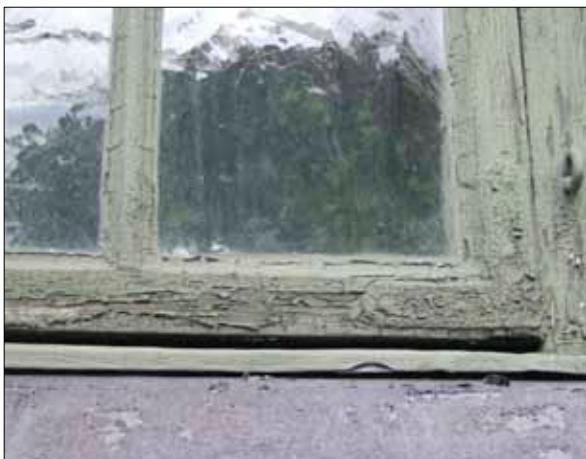
11 Fönstren var i stort behov av kittning och målning. Ca 80% av kittet fick bytas ut. (D10-851)
