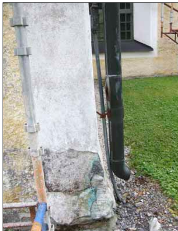
12 Putsbortfall förekom vid långhusets nordöstra hörn. (D10-853)
