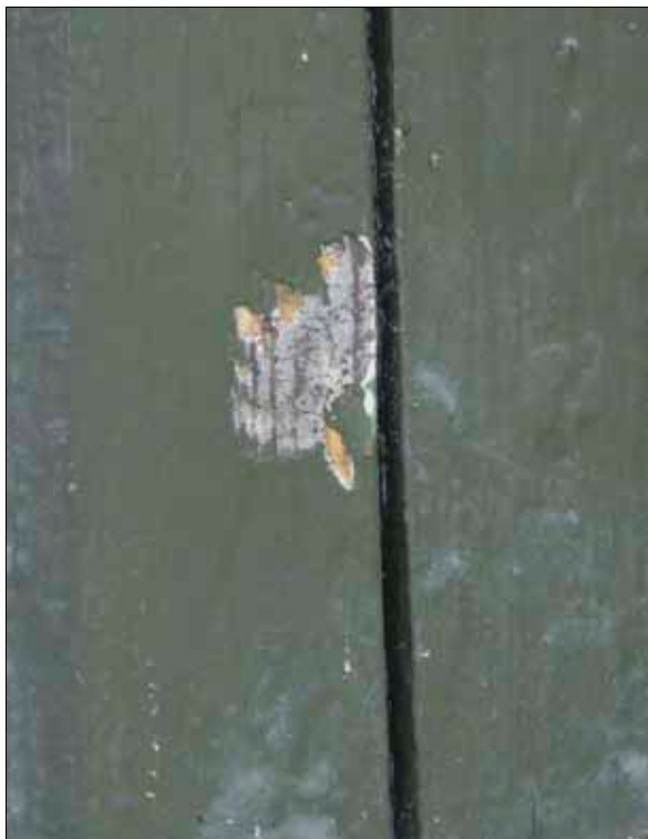
10 Färgskikt på sakristians fönster, där underliggande järnoxidbruna och grå färglager syntes.
