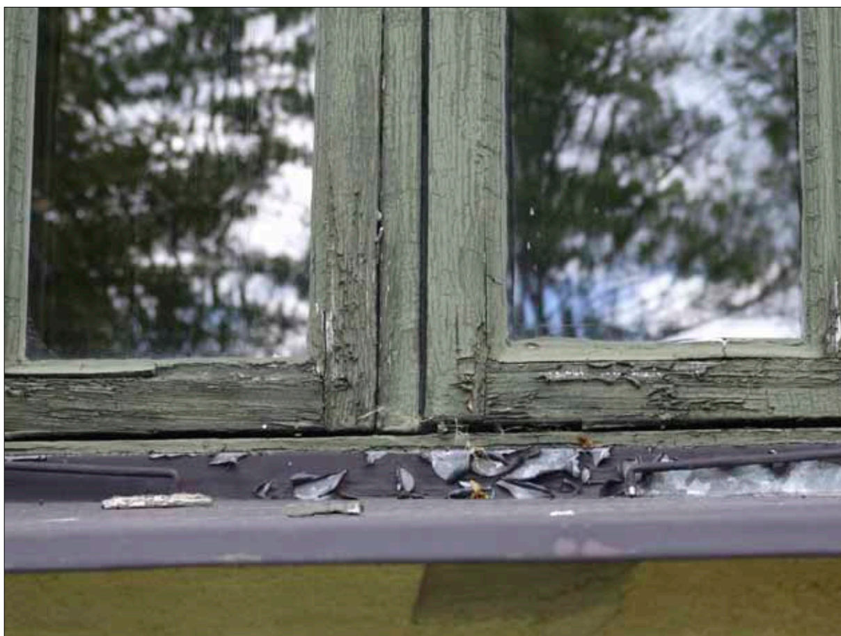
8 Fönsterbågarna var i stort behov av renovering, med krackelerade färgskikt och sprucket fönsterkitt.
