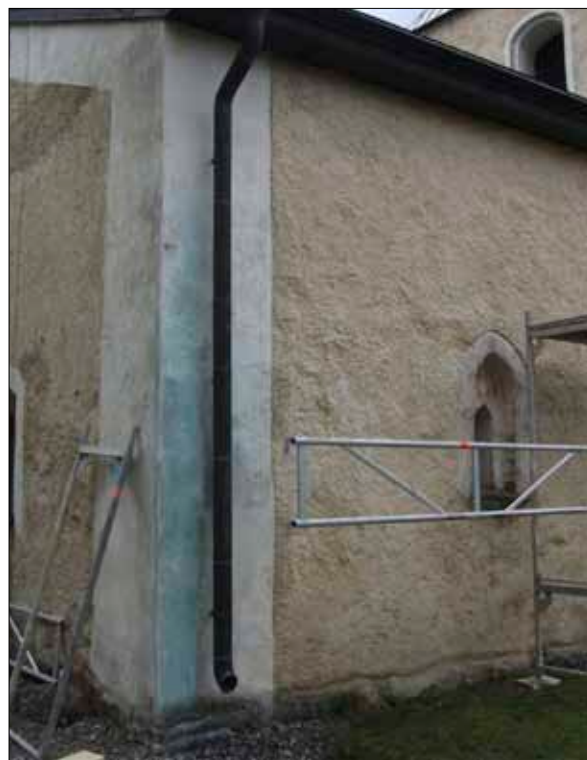
7 Kopparutfällningar från stupröret förekom på den släta omfattningen i kapellets nordöstra hörn.
