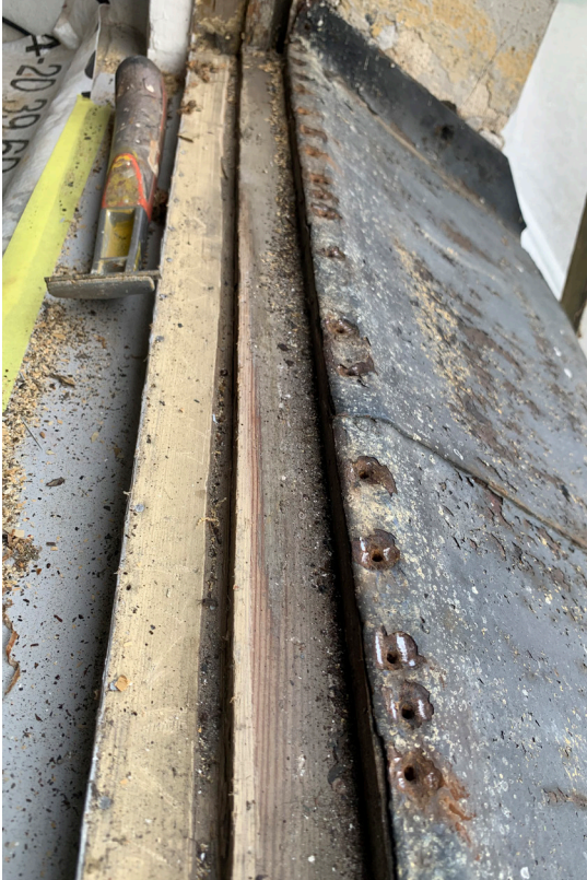
Bild 18. Bilden illustrerar konstruktionsproblematiken med vatten som tränger in mellan plåt och fönsterbågar. SLM D2024-0018.
