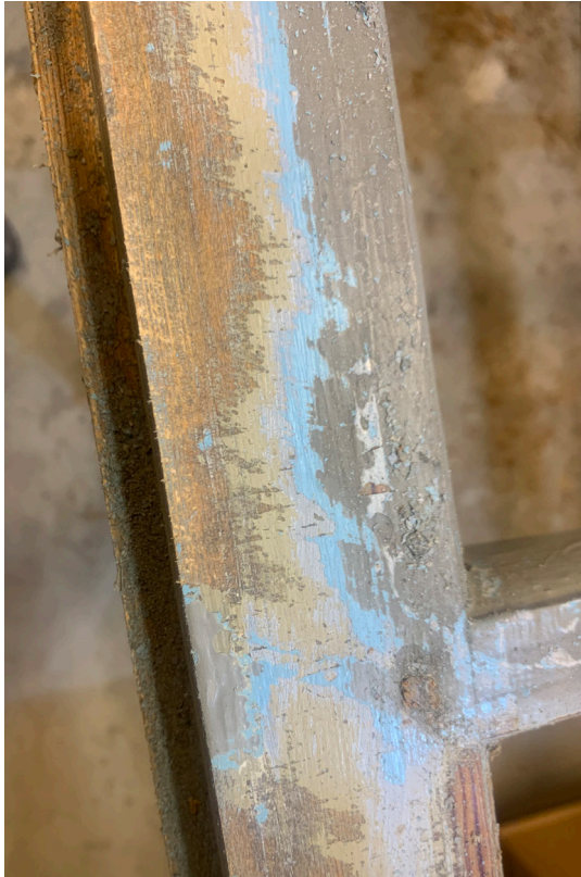
Bild 14. Äldre färgskikt på ett av de stora fönsterpartierna. Foto av Thomas Lundqvist. SLM D2024-0014.
