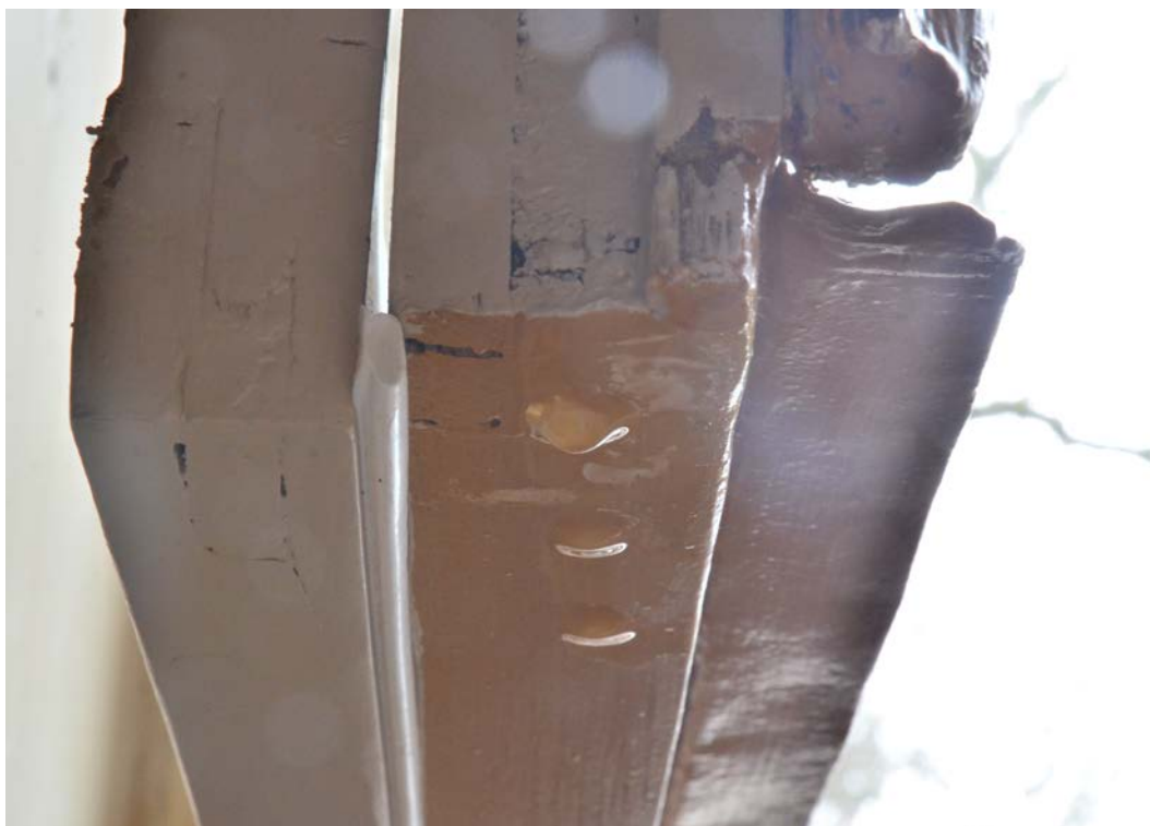
Bild 20. A5-fönstret efter renovering. Mellanrummen mellan bågarna har ökats ett par millimeter för att uppnå bättre ventilation av kondensluft. Vattendropparna på ytterbågens undersida visar på problemen med inträngande fukt, som dock hoppas kunna åtgärdas med hjälp av självhäftande dammlister. Foto 2023-03-20. SLM D2023-0213.
