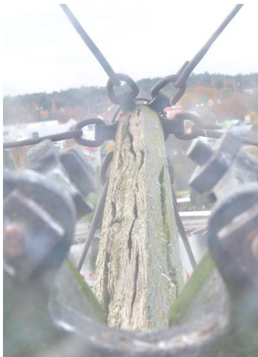
Rötskadat peke. SLM D2022-0672.
