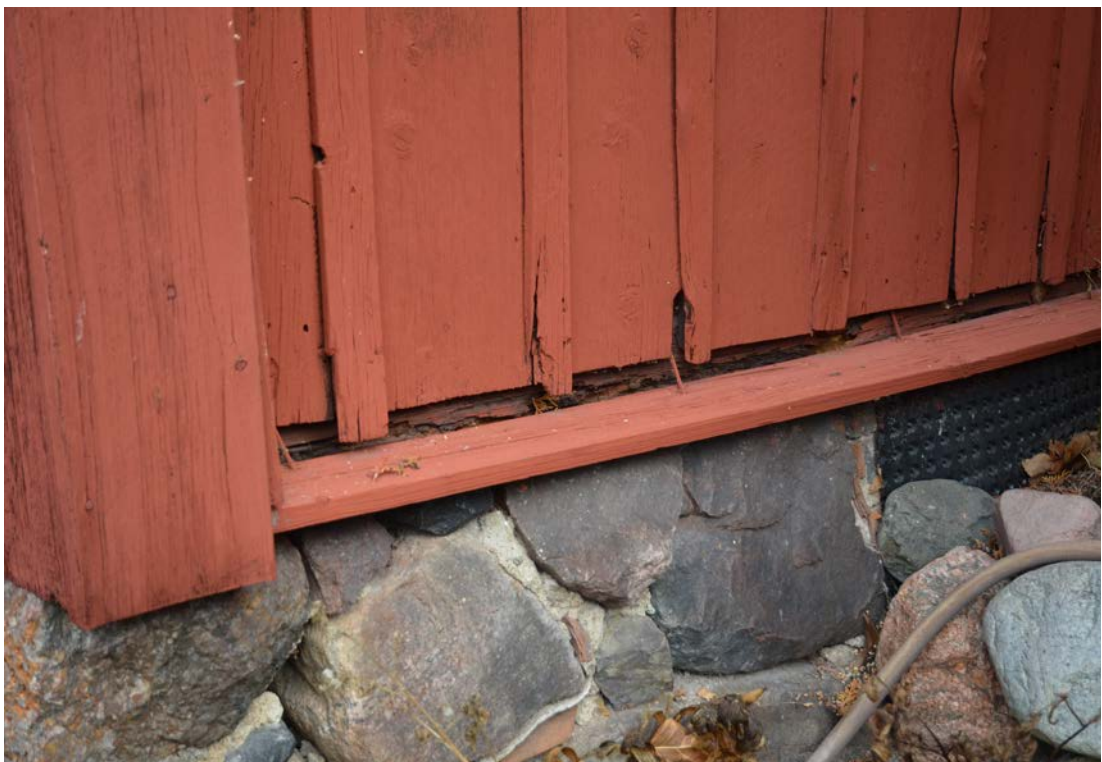
Bild 10. Skadad vattlist, panel och syllstock på fasaden mot väster. Foto 2018-11-15. SLM D2020-0198.
