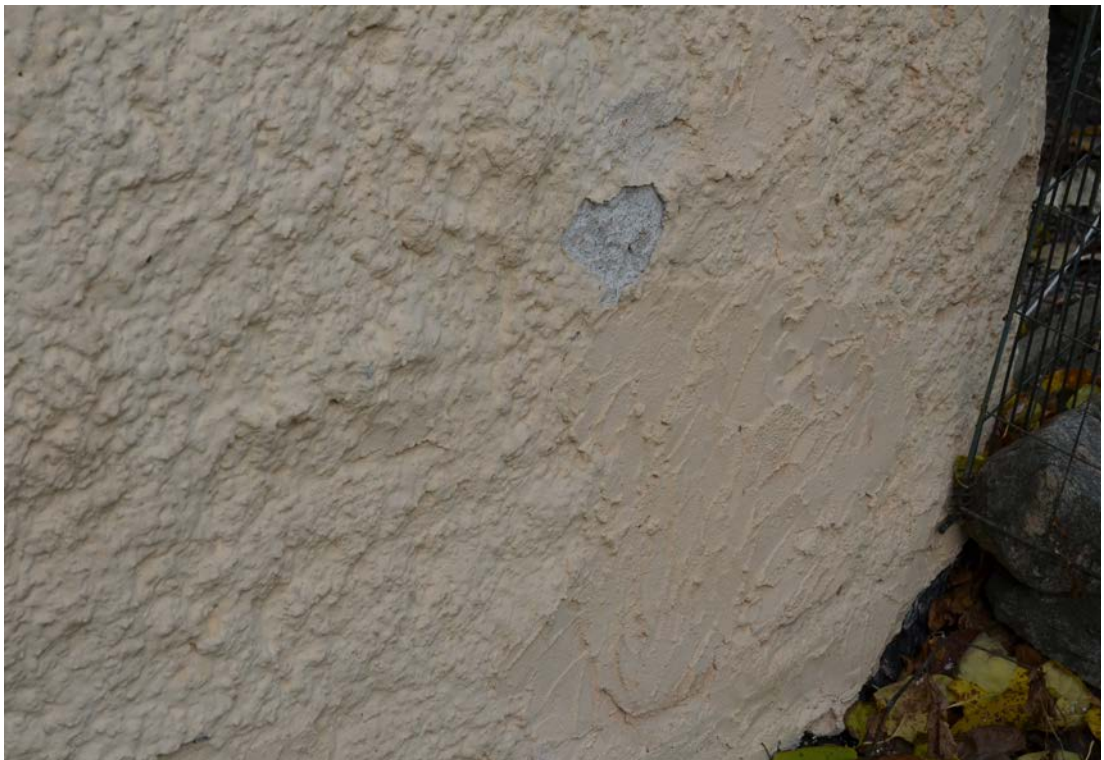
Bild 6. Skämmande lagningar på gårdshusets västra fasad. Foto 2018-11-15. SLM D2020-0194.
