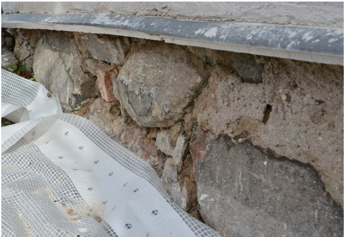
Bild 19. Stensockeln på östra gaveln med kvarvarande rester av cementbruk. Foto 2019-08-13. SLM D2020-0207.
