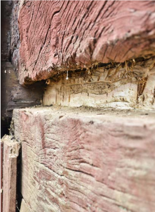
Bild 24. Hål i norra fasadens östra del, efter att rötskadad splintved tagits bort. Foto: 2020-03-10. (SLM D2020-0761)
