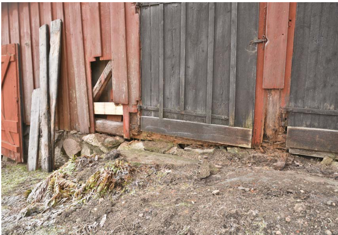
Bild 21. Rötskadad syllstock under tredje och fjärde dörren räknat från öster (norra fasaden). Foto: 2019-12-19. (SLM D2020-0758)
