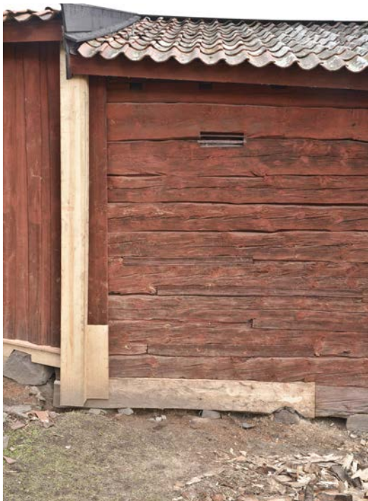
Bild 30. Skarvad syllstock på södra fasadens östra del, samt en renoverad knutlåda. Foto: 2020-02-17. (SLM D2020-0767)
