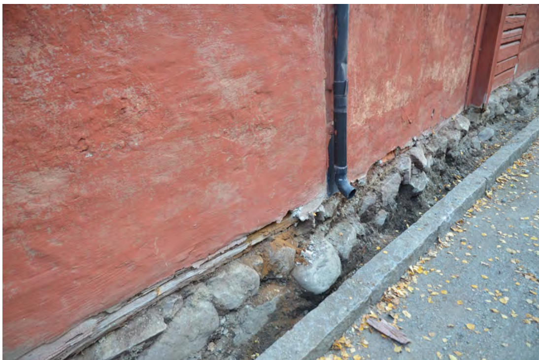
Tredje och fjärde facket (se beskrivning på sid 19). Syllen i fack 3 (hitom stupröret) var mycket rötskadad. Notera plåtbeklädnaden bakom stupröret. Foto 2018-10-12. SLM D2019-0637.
