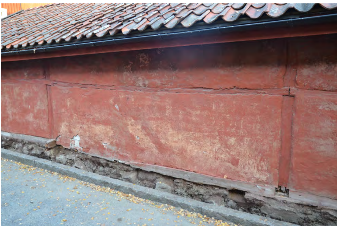
Rötskadad syll i andra facket (se beskrivning på sid 19). Foto 2018-10-12. SLM D2019-0638.
