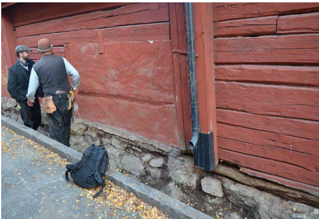
När marken intill grunden grävts ur blottades de rötskadade syllarna och stolparna, här i fack 5 och 6. Knutlådorna var delvis täckta med svart plåt. På bilden syns timmermännen från Nordins Byggnadsvård. Foto 2018-10-12. SLM D2019-0636.
