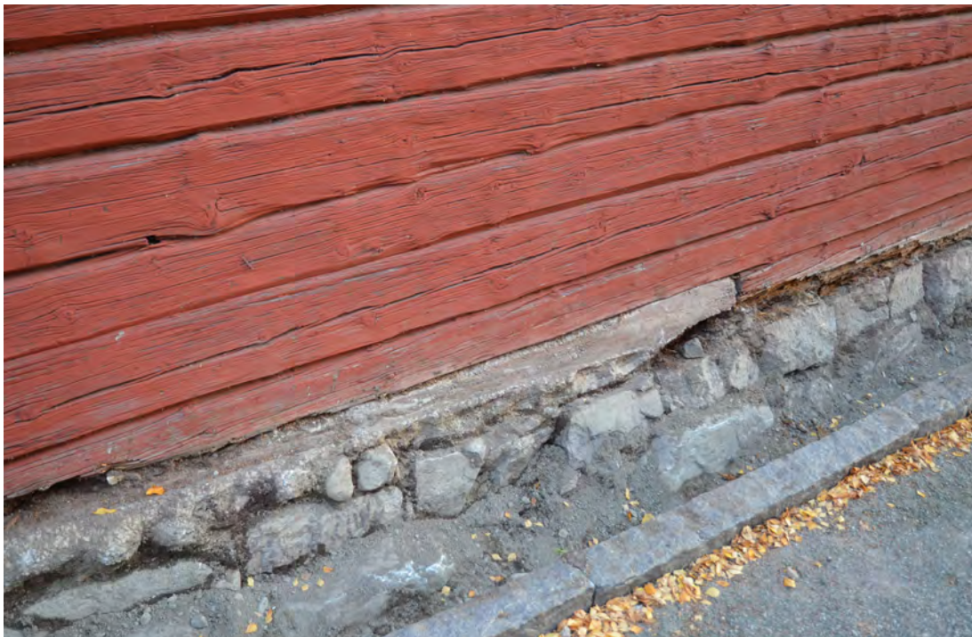
Syllen i fack 7 (se beskrivning på sid 19) var ersatt med gjuten betong som påskyndat timrets nedbrytning. Foto 2018-10-12. SLM D2019-0635.
