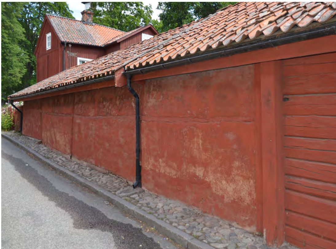
Bodlängans västra fasad i korsvirkeskonstruktion mot Kyrkogatan. Fasad mot Kyrkogatan innan renovering. Marknivån var så pass hög att syllstockarna i stort sett låg under mark. Ytputsen av kalkcementbruk, ifyllningarna med betong och kullerstenarna som fixerats med betong utgjorde en mycket effektiv absorbering av stänk och markfukt. Foto Kjell Taawo, Sörmlands museum, 2017-07-20. SLM D2019-0598.
