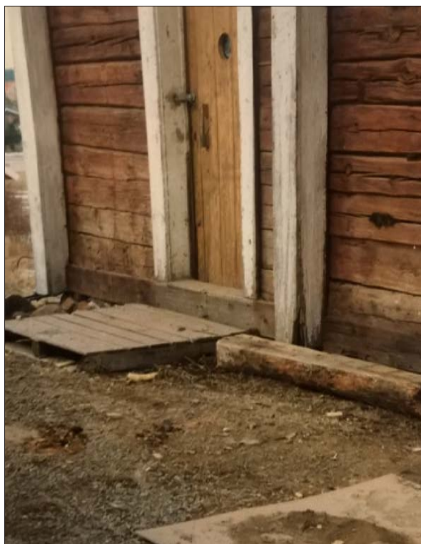
19 Entré år 1984. Dörren gick inåt som är brukligt på äldre hus. Fotograf Urmas Bergfeld, Strängnäs kommun.
