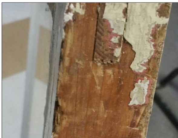
15. Detalj av fönsterkarm, vid skrapning framträder den ursprungliga färgsättningen. Fotografiet taget av målare Thomas Lundqvist. SLM D2016-2433
