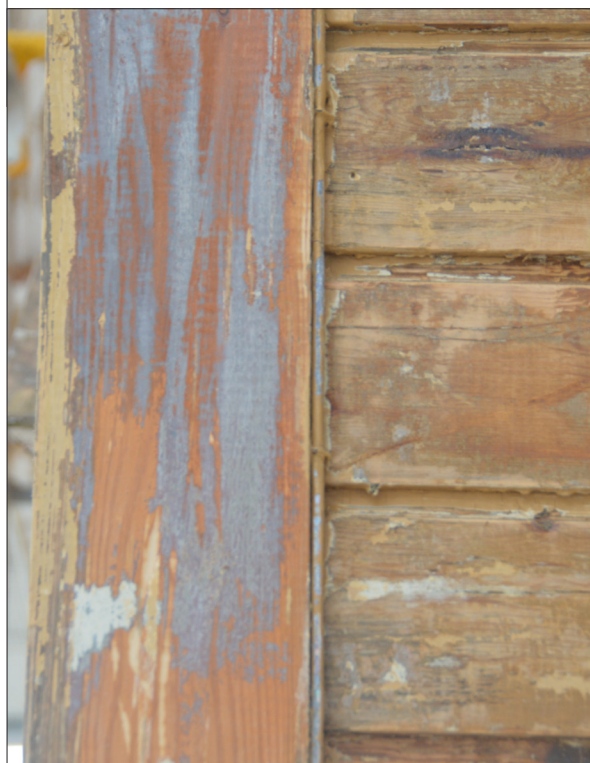
19. Knutbräda på framsidan av stationshuset. Vid skrapning av färglager tittades rester av en blågrå kulör. SLM D2016-2436
