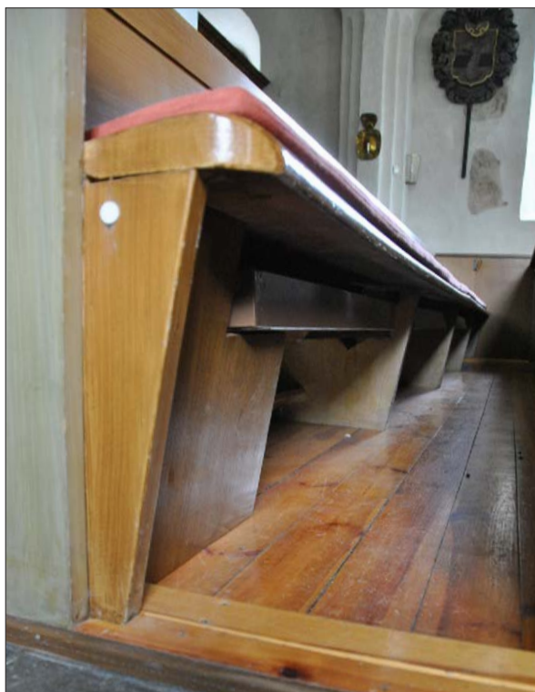
13 De nya bänkkonvektorena målades in i brun kulör (Slm D2015-1083).
