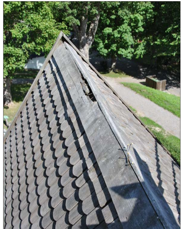
25 Långhusetsnockbräddor före utbytet (SLM D2015-1095).
