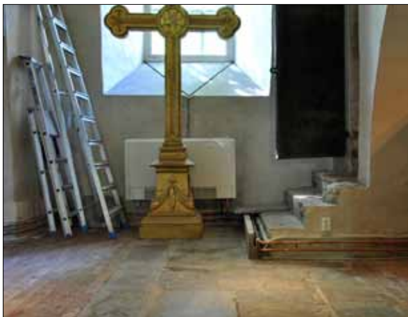
30 Fläktkonvektor och värmeledningsrörinstallationer i tornets bottenvåning (Slm D11-164).
