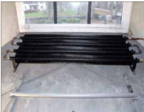
32 Kamflänsradiatorer i fönstret bakom altartavlan (Slm D11-166).
