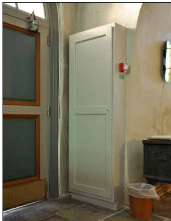
28 Skåpsinredningen till vänster om kyrkans huvudingång döljer centraler för brand- och inbrottslarm (Slm D11-162).
