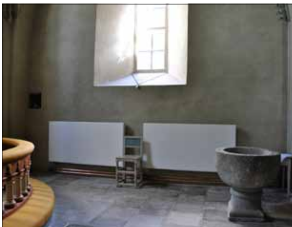
31 Släta, panelradiatorer på korets södra vägg (Slm D11-165).
