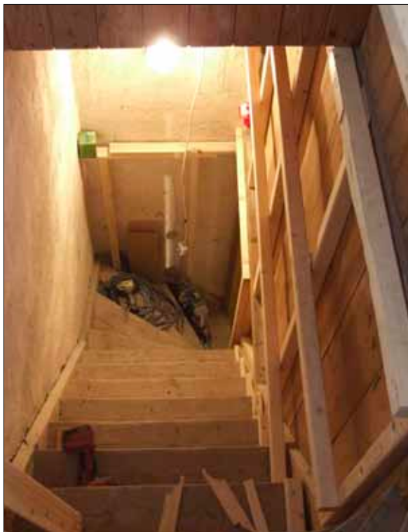
28 Trappan i tornet sett ned mot västra entrén. Vägg mot entrén isolerades.
