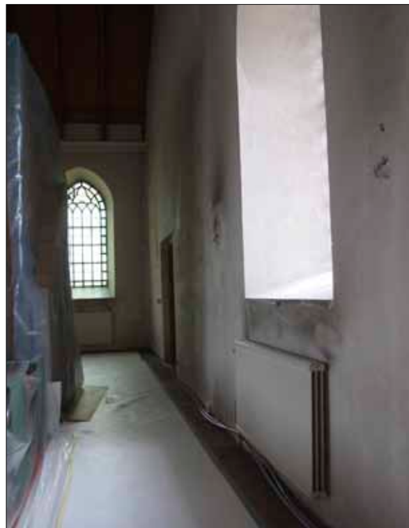
14 På väggen bakom altaret var det en putsskada, där det varit en vattenläcka.
