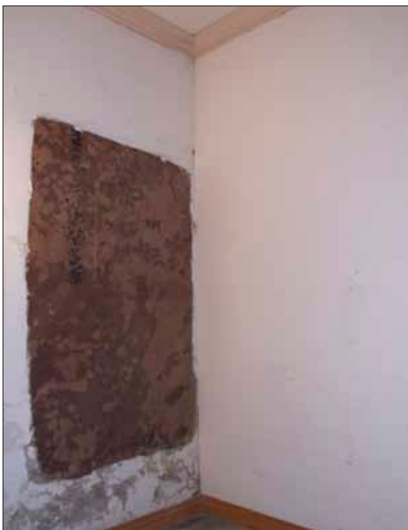
24 Putsen nedtill på södra väggen var skadad.
