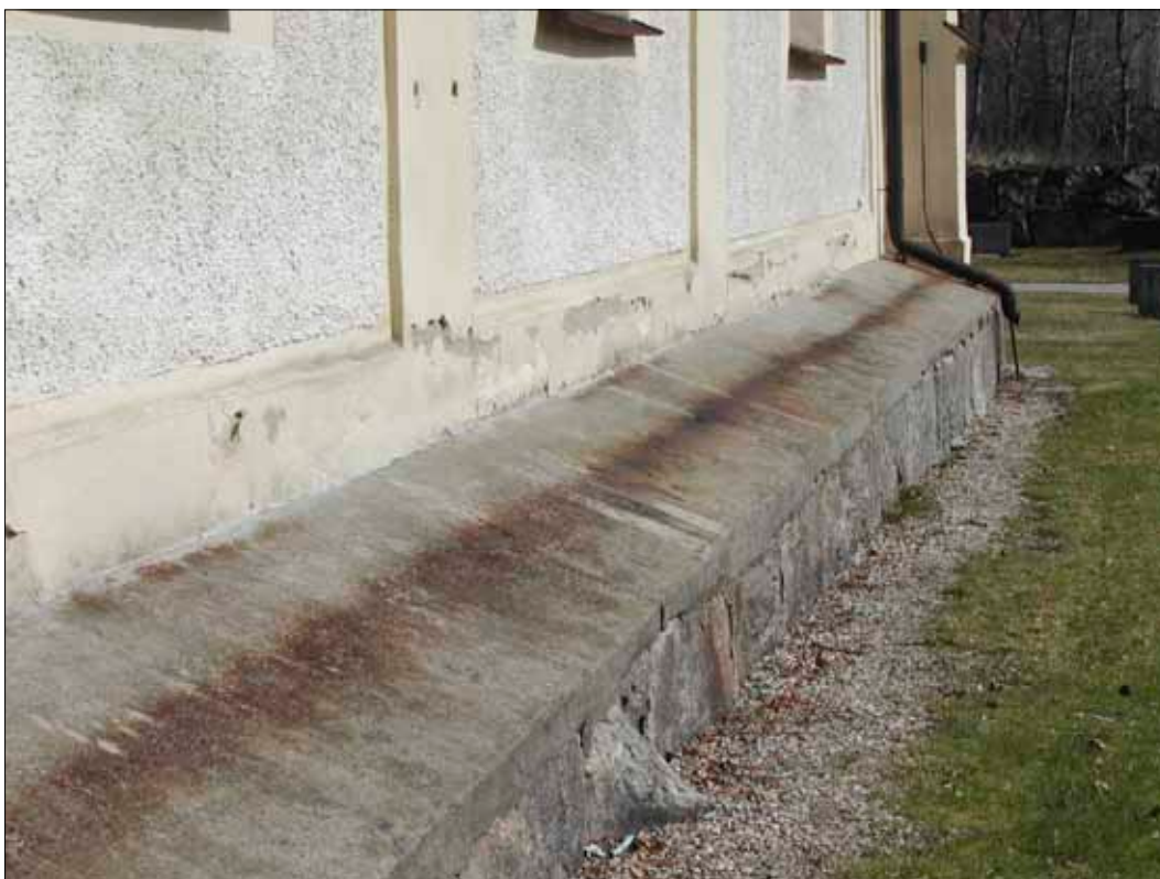
Fig 11 Den nedre arkitektoniska avslutningen längst ner på den södra långväggen mot betongggjutningen orsakade fuktskador och togs därför bort 2005.
