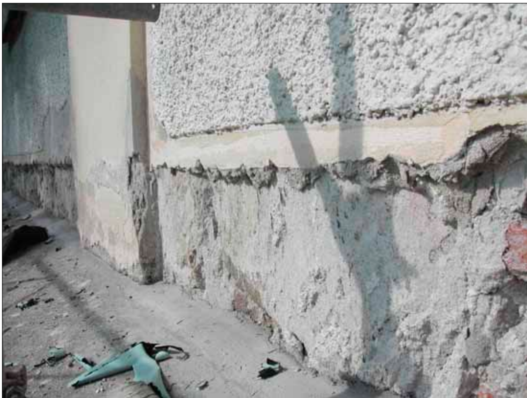
Fig 17 Borthuggen fasadlist på sydväggen. Det gröna skräpet är takfärgen från 1970-talet, som togs bort i stora sjok eftersom den innehöll plast.
