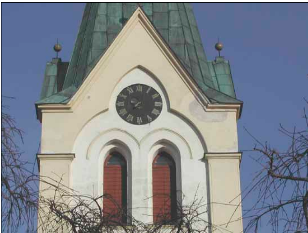
Fig 8 En putsskada fanns på tornets västra del.
