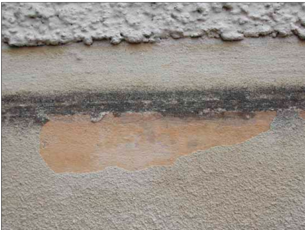
Fig 12 Putskulören under ytskiktet stämde bra med förväntad järnvitriolgult som hör samman med tiden 1880 och med arkitekten Langlets färgval på sina byggnader. Även putsytan är mera korrekt än ytskiktet som hör till 1960-talet.
