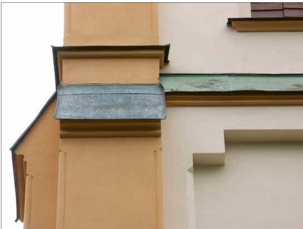
Fig 20 Här i originalutförande ansluter putsen på traditionellt sätt mot plåten med en obetydlig friskärning med murslev för att tillåta viss rörelse.
