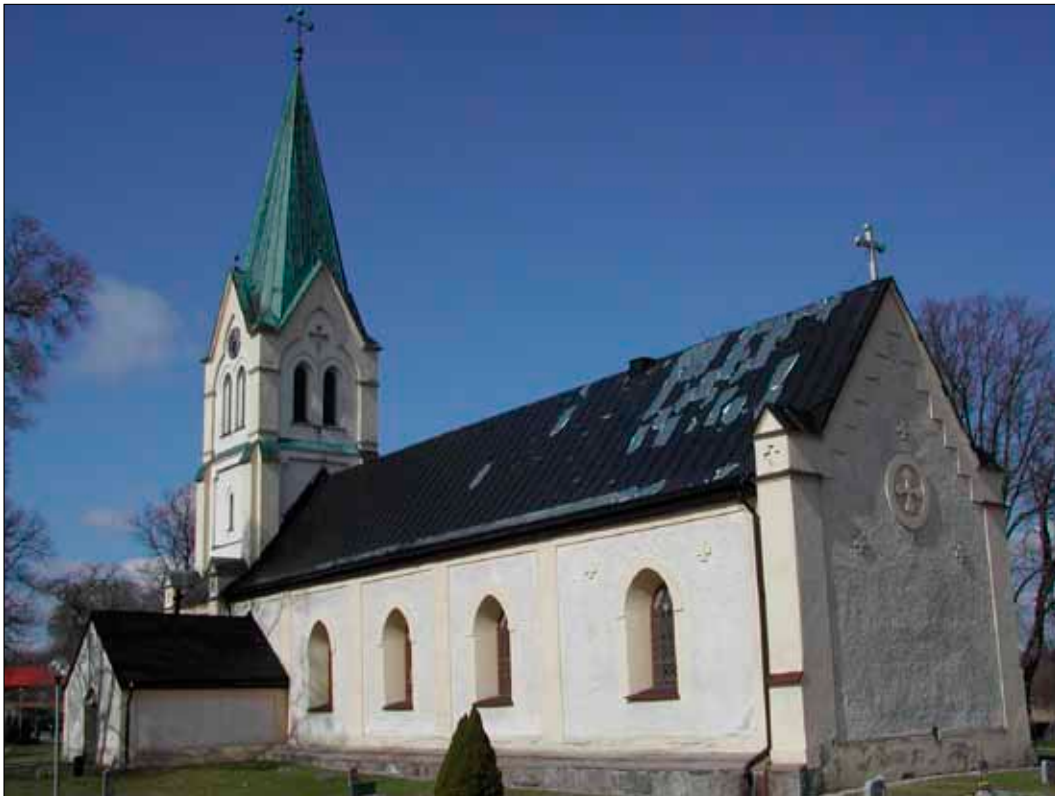
Fig 6 Helgarö kyrka före upprustningen 2005. Takfärgen flagar, fasadernas putsyta och kulör härrör från 1960-talet. Sprickor finns under olika fönster.
