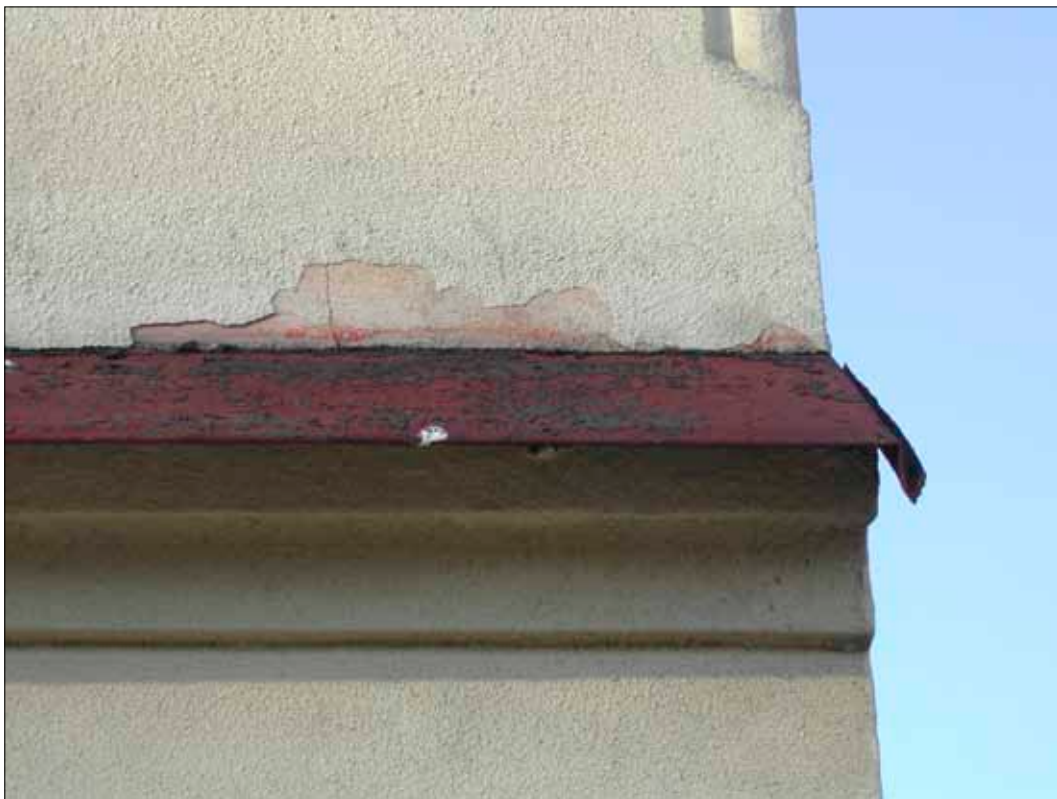
Fig 9 På den sydöstra strävpelaren var avtäckningsplåten av järn i stort behov av målning.
