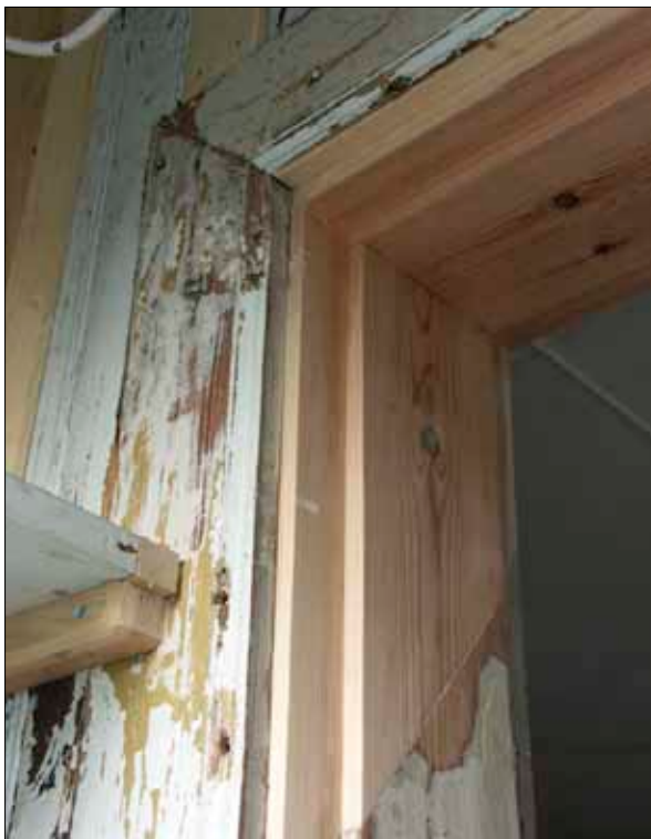
23 Dörrkarmen mellan förstugan och drängkammaren var rötskadad och fick lagas i.
