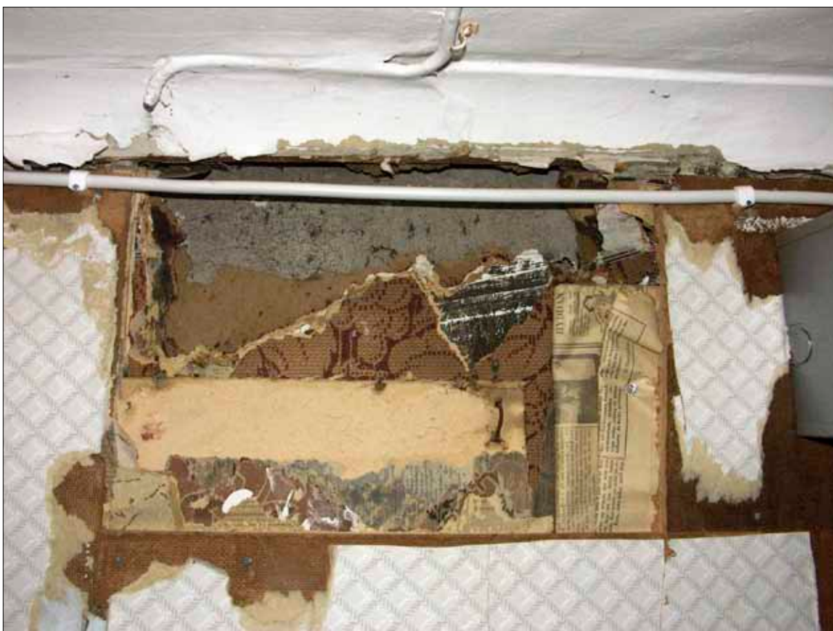
25 Under skivbeklädnaden fanns flera tapetlager.
