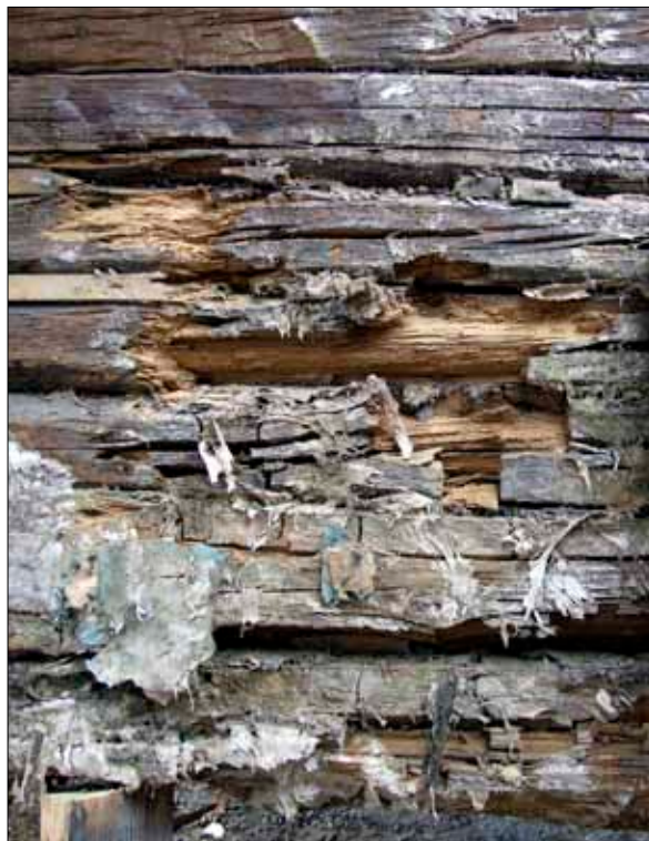
9 Hussvampsangripiet parti av byggnadens stomme, 20080303 (D08-652).
