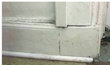
Bild 30. Golvlist på södra väggen.
