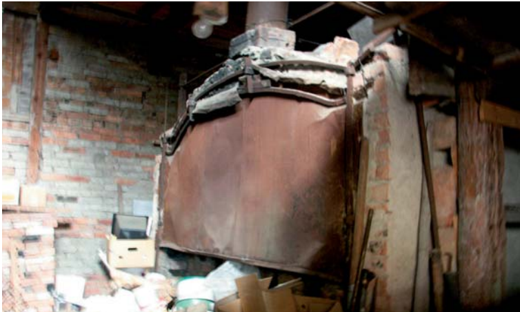
Bild 25. Ugnens baksida med isoleringsplåten som samlar in röken.
