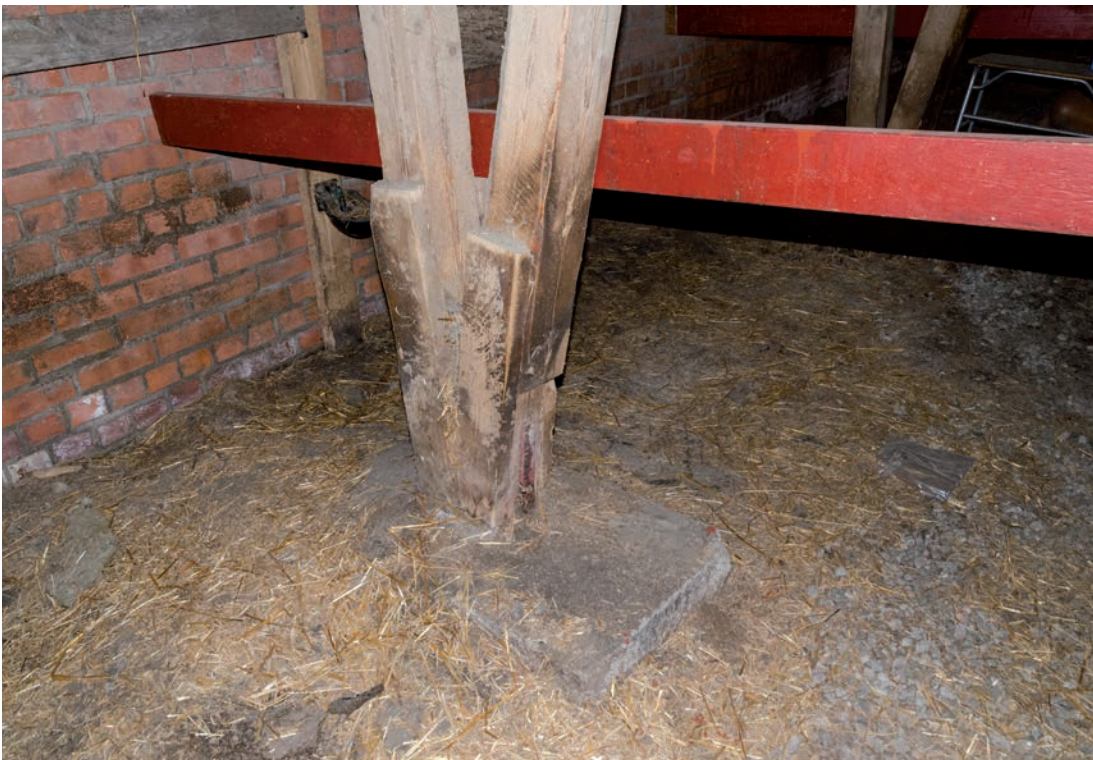
En av takstolarnas stödben som vilar på betongklackar. Stödbenen, som tidigare har skarvats, var rötskadade i olika grad. (SLM D2019-0089)
