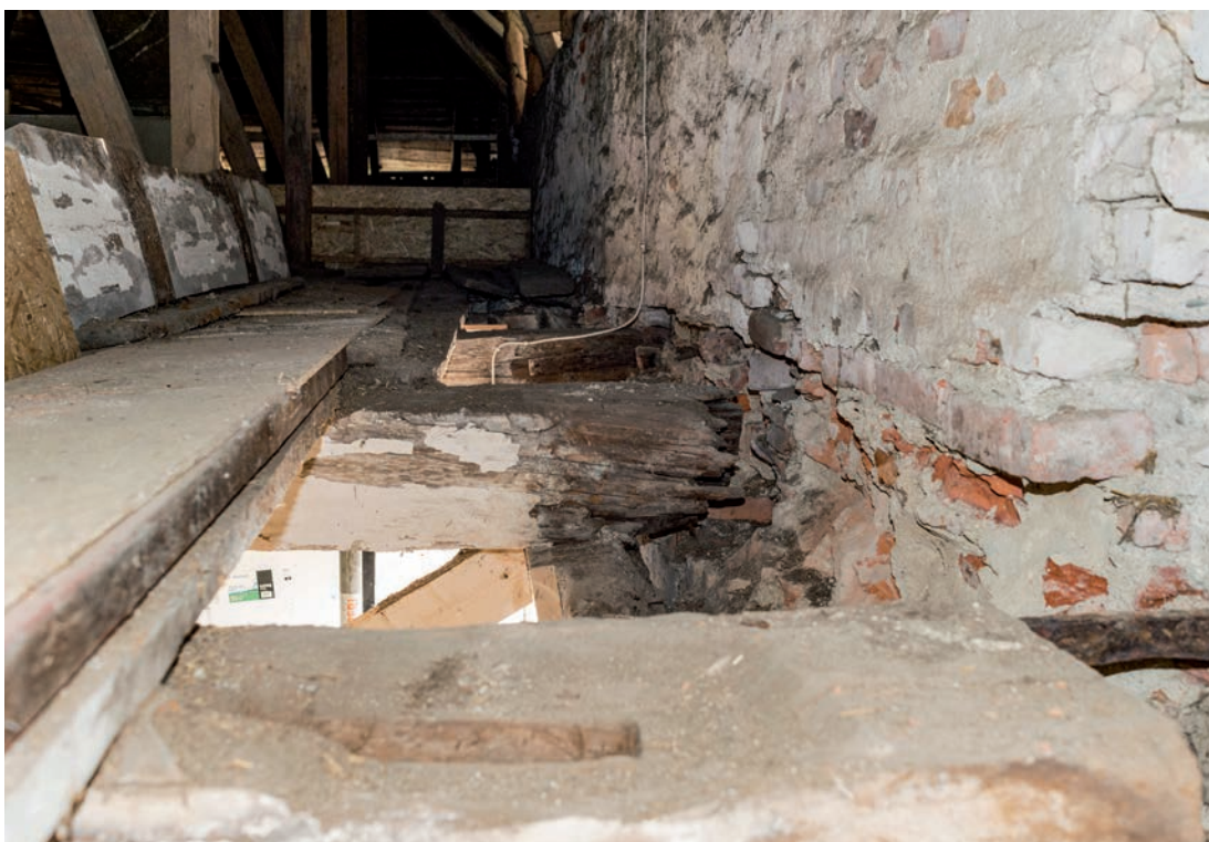
Bjälkarnas östra ändar sett från vindsvåningen. Ändarna är kraftigt rötskadade och ankarjärnen har lossnat. (SLM D2019-0085)
