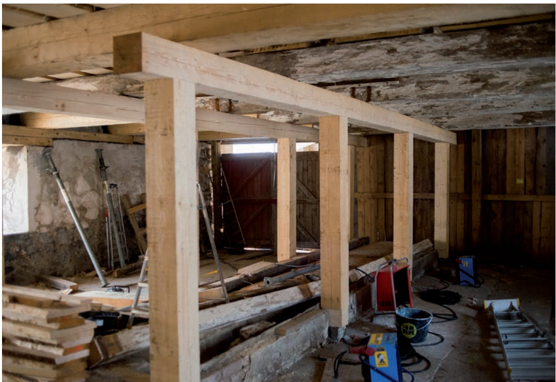
Det nya forderbordet fotograferat i samband med byggmötet 20171120, vilket hade satts dit utan samråd med antikvarie. Både stolpar och bärlinor är grövre än den äldre konstruktionen. (SLM D2019-0101)
