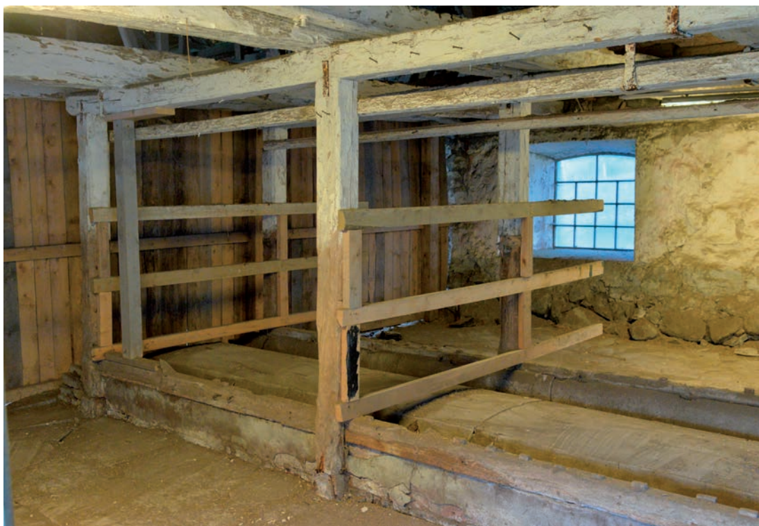
Kostallets foderbord före åtgärd. Notera resterna efter spjälor i de längsgående bjälkarna på foderbordet. Stolpar och bärlinor är tappade och sammanfogade med korta plattjärn. Bärlinorna är i sin tur sammanfogade med bjälkarna genom u-formade plattjärn. Foderbordet är murat av tegel och putsat. (SLM D2019-0086)
