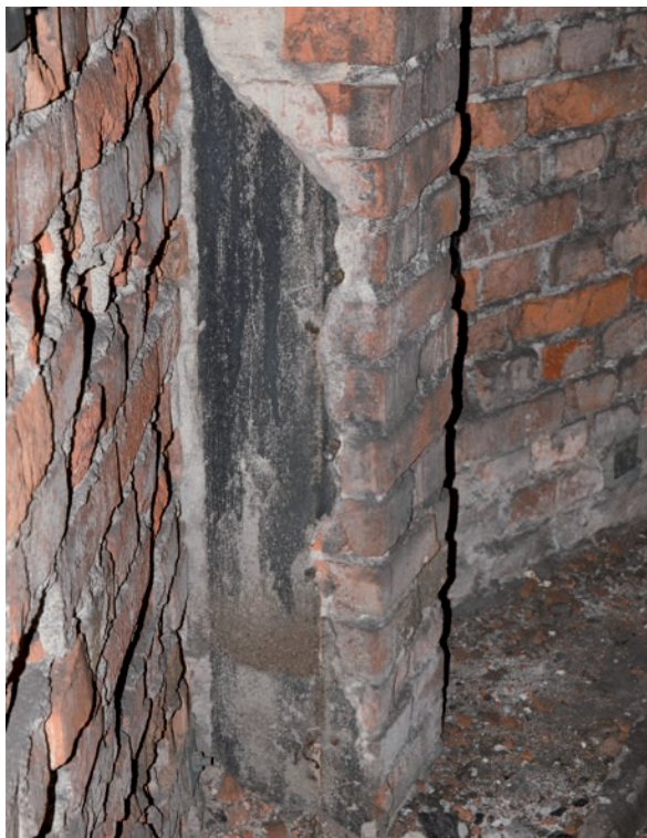
(5) Rester efter putsskikt på femte våningen. Putsen togs möjligen bort i samband med att tornets övre del kläddes med kopparplåt. (SLM D2016-2712)
