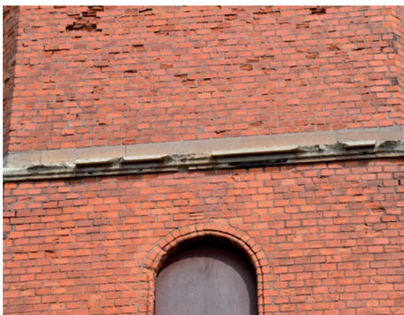
(S) Den nedre kalkstensfrisen har stora vittringsskador med urspjälkning som följd. (SLM D2016-2667)
