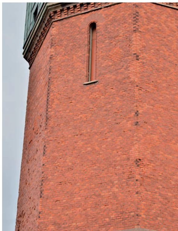
(SO) Hela sidan har vittrade tegelstenar i mindre utsträckning. Lagade partier från 1985 års renovering syns i de ljusare partierna till höger. (SLM D2016-2671)
