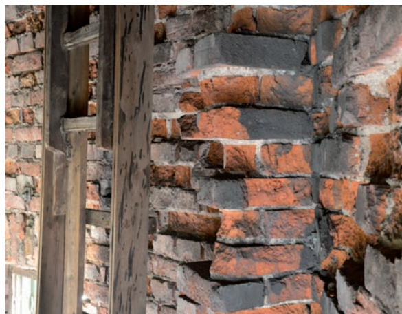
(5) Parti av vägg vid samma ställe som ovan med stor mängd vittrat tegel efter brister i avvattning. (SLM D2016-2708)
