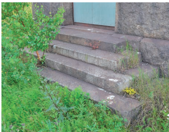
(NV) Entrétrappan är idag igenvuxen av ogräs och en björk som bör avlägsnas för undvika skador. (SLM D2016-2657)
