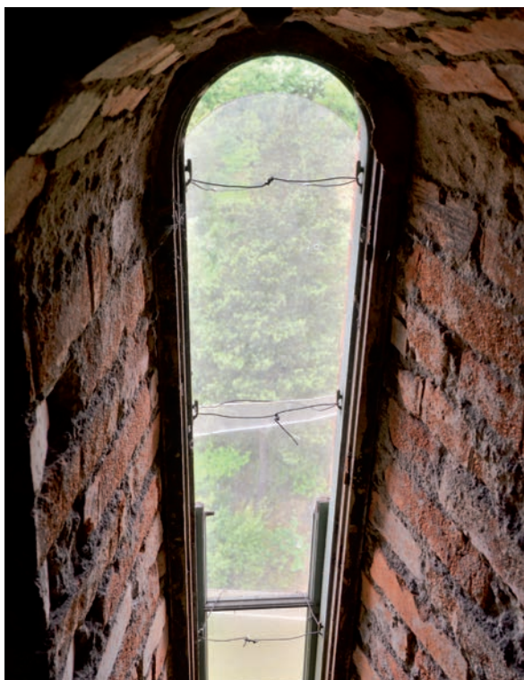
(4) Ett av fönstren har en trasig bäge. Akrylplastglaset som är placerat utanpå bågarna har lossnat och hänger i en ståltråd. (SLM D2016-2702)
