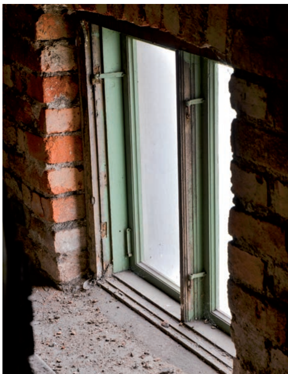
(5) Ett av de nedre fönstren på femte våningen. Glaset i bågar har ersatts med en utanpåliggande skiva med ofärgad akrylplast. (SLM D2016-2713)
