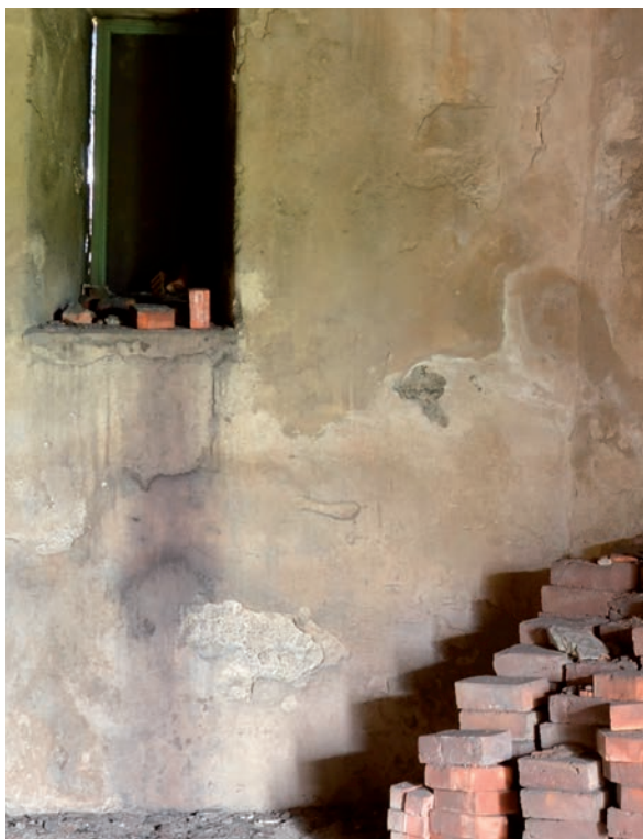
(BV) Ytputsen har släppt på en del ställen. (SLM D2016-2681)
