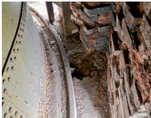
(5) Avvattningsrör som leder ner till våningen under, saknar anslutning. Notera den vittrade tegelväggen. (SLM D2016-2706)
