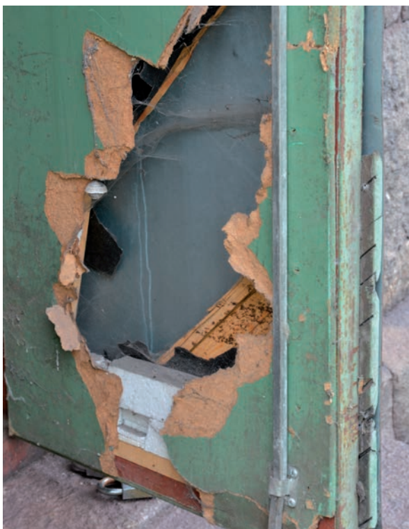
(NV) Dörrarna har kvar sin snedställda spontade panel under plåten. Den högra dörren saknar några brädor och har ett större hål i den invändiga masonittäckningen. (SLM D2016-2656)
