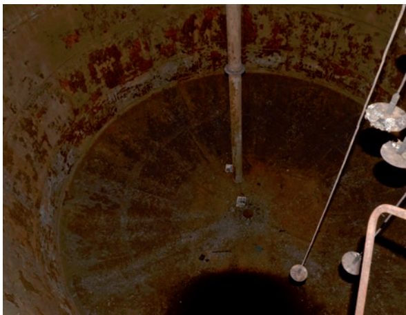
(5) Vattencisternens insida med uppstickande rör för tillflöde och intill detta utloppsöppningen. Till höger syns elektriska sensorer som mätte vattendjupet. (SLM D2016-2709)
