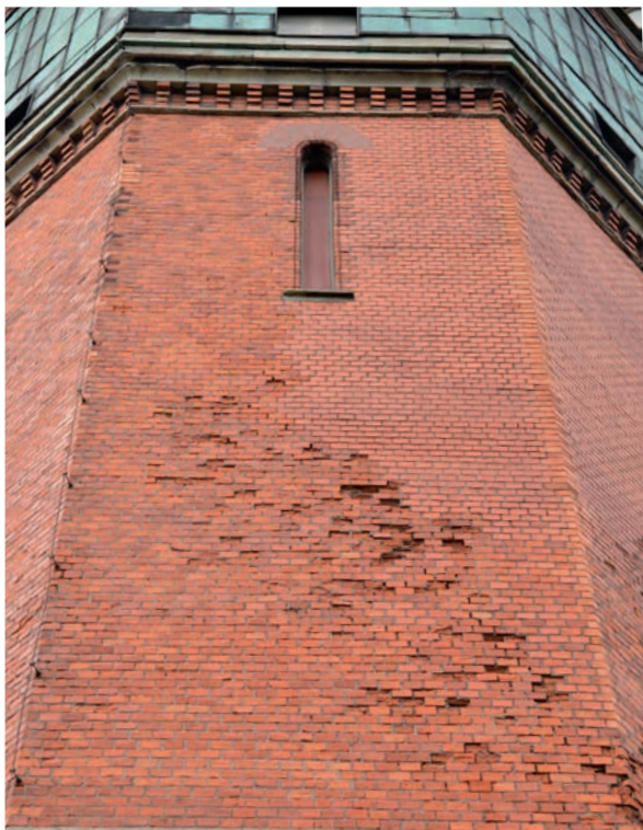
(Ö) Det större lagade partiet vid 1985 års renovering syns till höger. Det icke utbytta teglet har stora vittringsskador med urspjälkade partier. (SLM D2016-2675)
