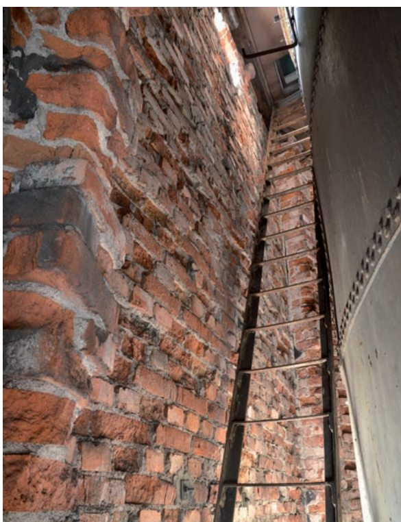
(5) Stege mellan vägg och vattencistern som leder upp mot luckan till taket. Väggen har en stor mängd vittrat tegel. (SLM D2016-2705)
