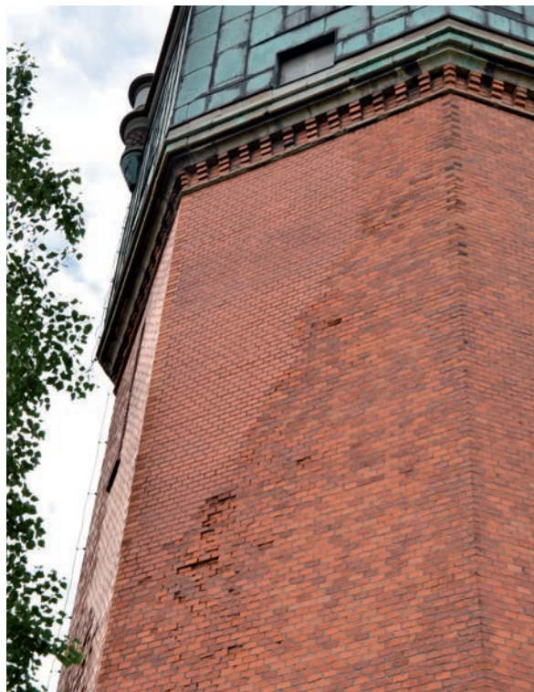
(N) Den norra fasaden med det större sammanghängande partiet utbytt tegel till vänster. Nya skador har uppstått efter frostsprängning runtom lagningen. (SLM D2016-2653)
