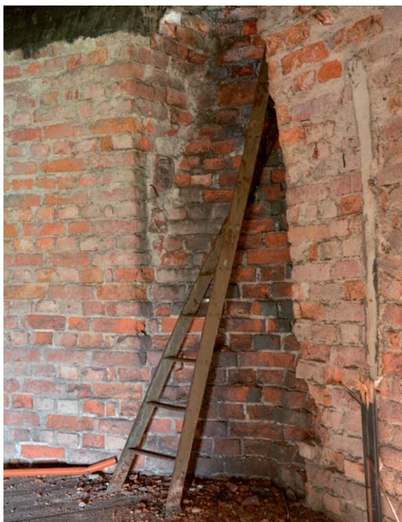
(4) Stegen upp till femte våningen. Vittrat tegel har rasat ner från våningen över. (SLM D2016-2703)
