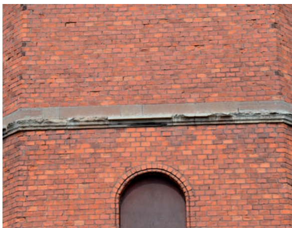
(SO) Den nedre kalkstensfrisen har vittringsskador med urspjälkning som följd. (SLM D2016-2673)
