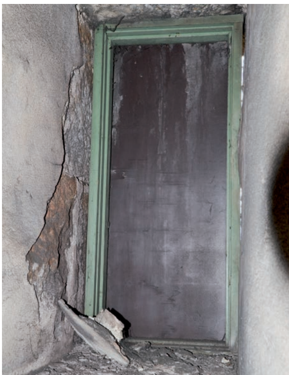
(BV) En av fönsteröppningarna i bottenvåningen. Vissa bågar saknas, och endast ett av fönstren har kvar sina glas tillsammans med en tvärgående spröjs innanför plywoodskivan. Puts har släppts från väggen i fönsternischerna. (SLM D2016-2682)
