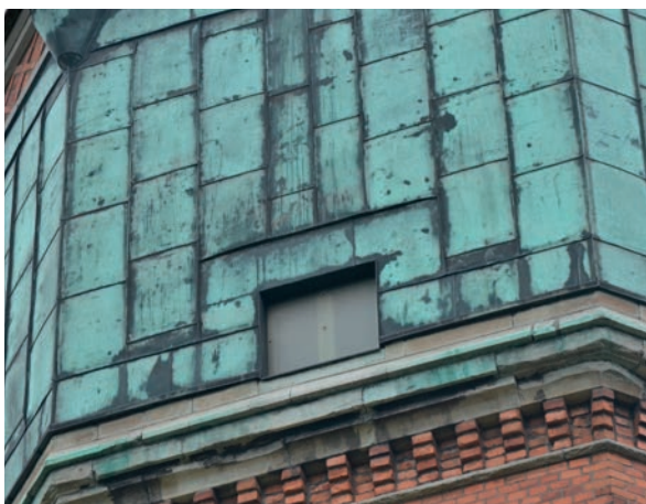
(V) Mindre skador finns på kalkstensfrisen under den plåttäckta delen. Kalkstenen har färgats av regnvatten från kopparplåten. (SLM D2016-2661)
