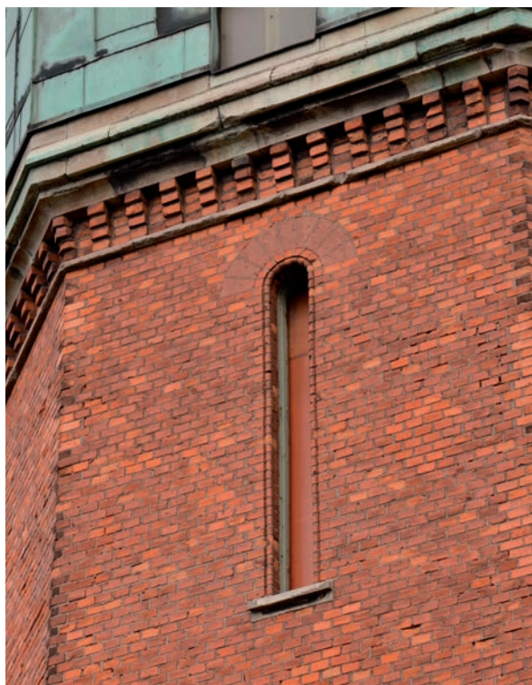
(SO) Fönstret saknar spröjs och glas men har täckts för från insidan. Solbänken har lagats med putsbruk. Vittringsskador finns i kalkstensfris och tegelkonsoler. (SLM D2016-2672)
