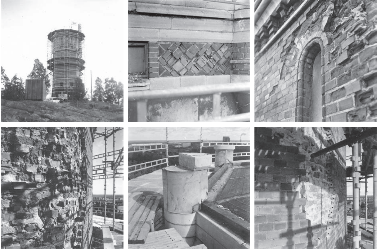
Bilder tagna i samband med renoveringen 1985. Skadorna bestod till stor del av frostsprängt tegel och vittrad kalksten. Nere till höger ett urhugget parti före lagning. (SLM K2:87)
