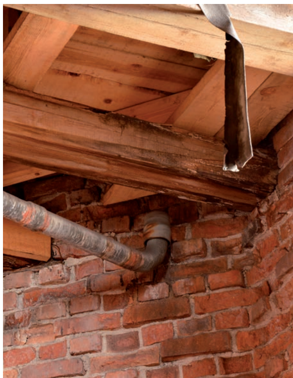
(3) Ett tidigare läckage har gjort att tegelväggen vittrat och golvbjälken tagit skada. Vid renoveringen 1985 lades golvet på nya tvärgående bjälkar för att inte belasta känsliga punkter. (SLM D2016-2694)
