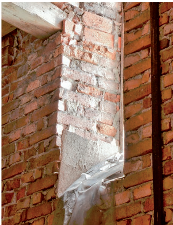
(3) Rester efter puts finns i fönsternischerna. (SLM D2016-2695)
