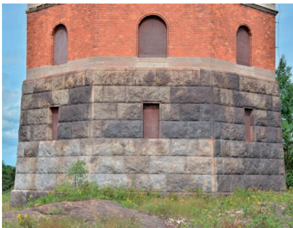
(S, SO, Ö) Stensockeln är hel, men mer eller mindre nedsmutsad. Fönstren i de nedre våningarna har på senare år täckts för med plywood. (SLM D2016-2669)
