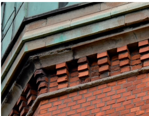
(S) Mindre vittringsskada vid kalkstensfris och tegelkonsol. (SLM D2016-2668)
