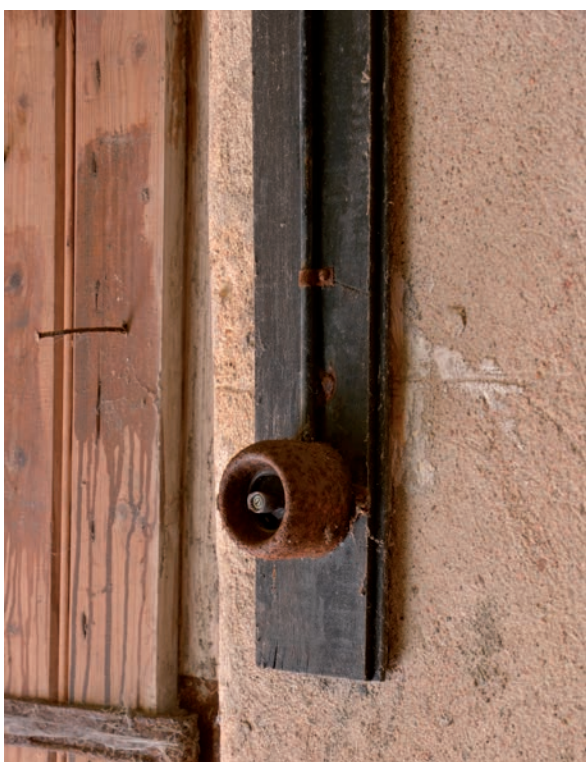
(BV) En äldre vridströmbrytare med hölje av metall. (SLM D2016-2683)
