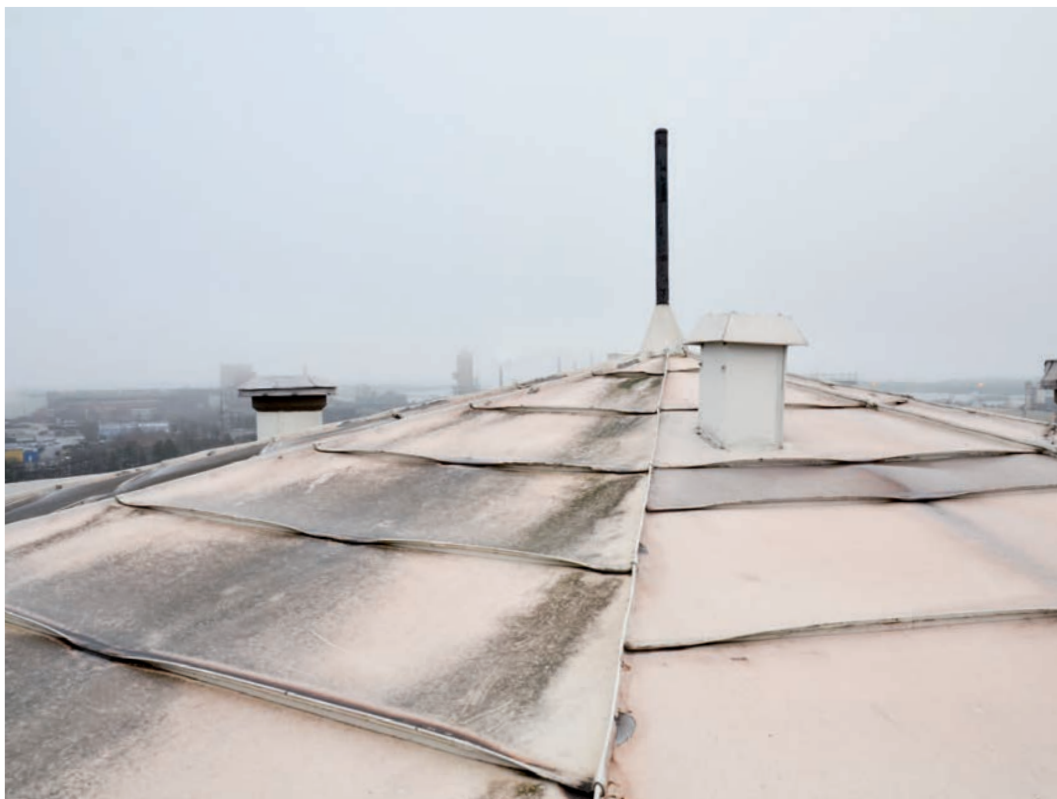
Takets mitt, med ventilationsöppningen närmast till höger i bild. Färgen på plåten har börjat flaga på en del ställen. (SLM D2016-2715)
