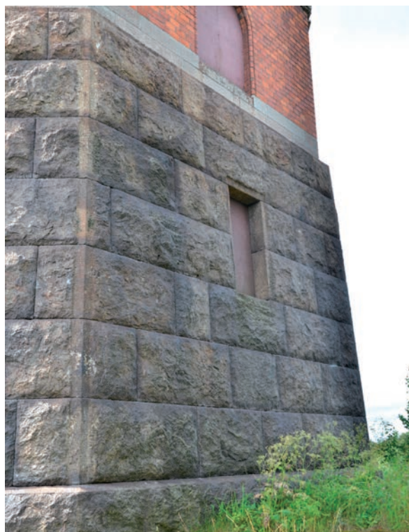
(N) Sockeln på den norra sidan är nedsmutsad men utan skador. Gräs växer nära in på sockeln vilket bör tas bort för att undvika fuktproblematik i bottenvåningen. (SLM D2016-2654)
