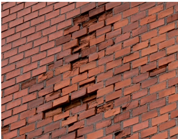
(N) Frostsprängt tegel nära det reparerade partiet. (SLM D2016-2650)
