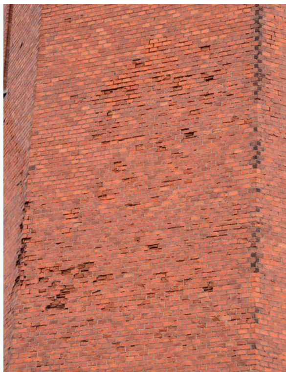
(S) En stor del av fasadteglet har vittringsskador. (SLM D2016-2670)
