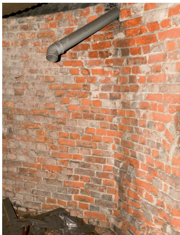
(4) Avvattningsrör från femte våningen som saknar anslutning. (SLM D2016-2698)
