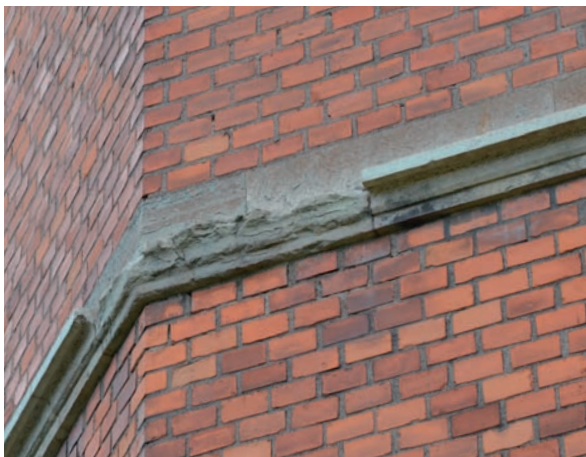
(V) Skada på den nedre kalkstensfrisen där en stor del har spjälkat ur. (SLM D2016-2660)
