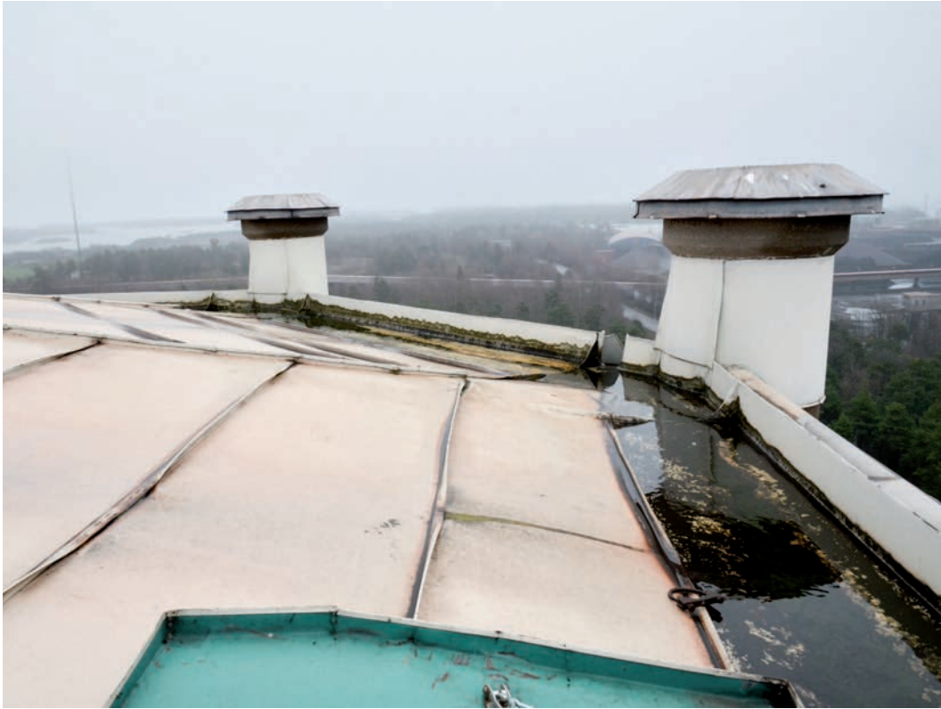
Vatten blir stående längs fotrännan på grund av dålig lutning. Till vänster om den högra tourellen finns en vattenutkastare. (SLM D2016-2716)
