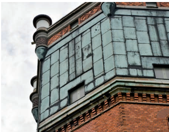
(N) Den norra sidan uppvisar enbart mindre vittringsskador på kalkstensfrisen under under den koppartäckta delen. (SLM D2016-2652)
