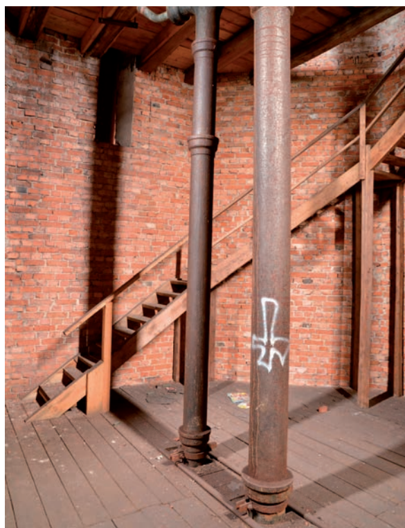
(3) Tredje våningen med rörledningarna och trappan upp till fjärde våningen. (SLM D2016-2692)
