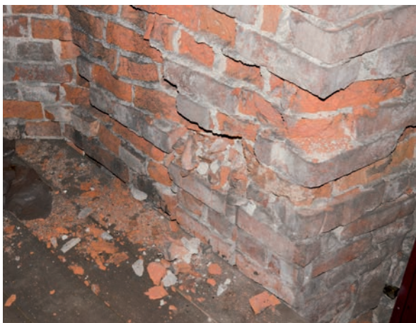
(4) Väggarna har flera skador med vittrat tegel, sannolikt efter brister i avvattningen. (SLM D2016-2701)
