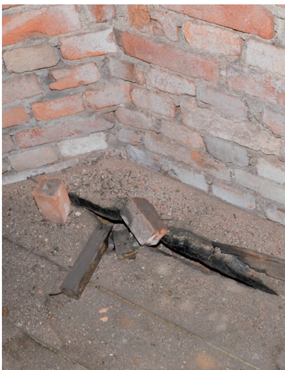
(2) En mindre skada i golvet där någon eldat finns nära väggen i norr. (SLM D2016-2691)
