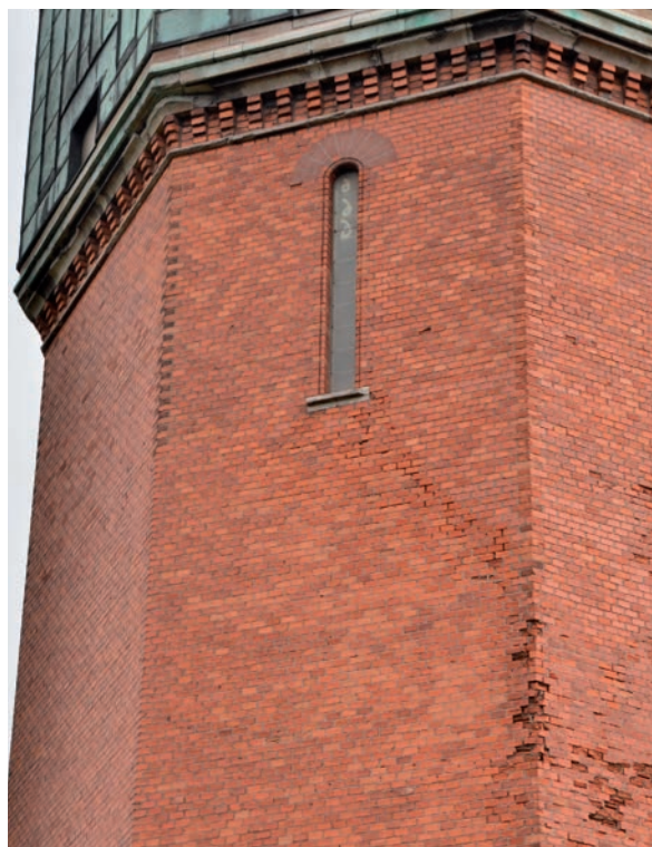
(SV) Vatten har runnit från fönstret och orsakat att fogbruket lakats ur, och närmre kanten med urspjälkat tegel. (SLM D2016-2666)
