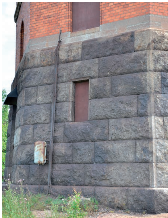
(V) Stensockeln är nedsmutsad. Ett äldre urkopplat elskåp sitter kvar tillsammans med elledningen till andra våningen. (SLM D2016-2662)
