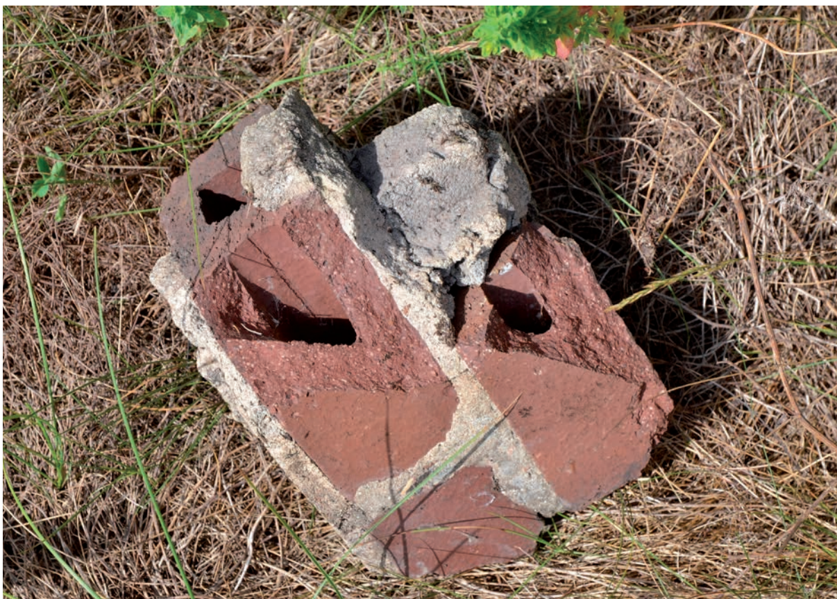
En bit fasadtegel med fogbruk som spjälkat ur efter frostsprängning. (SLM D2016-2649)
