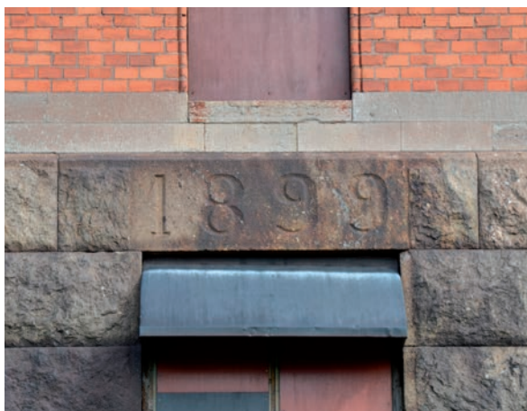
(NV) Stensockeln är nedsmutsad vilket gör att året över dörren numera är svårläst. (SLM D2016-2658)
