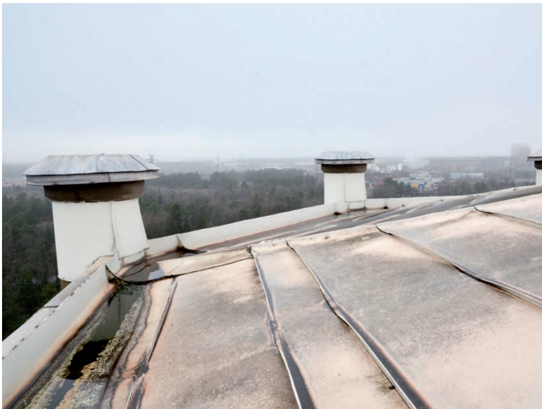
Taket är täckt med bandplåt med horisontella falsar. Vatten blir stående längs med fotrännan som har för få utlopp. Hörntourellerna plåttäcktes i samband med 1985 års renovering. (SLM D2016-2714)
