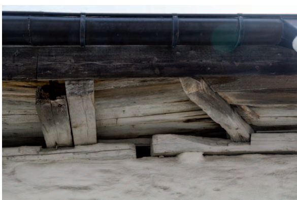
Takfoten nära hörnet med en snedställd sparre. (D2015-1005)
