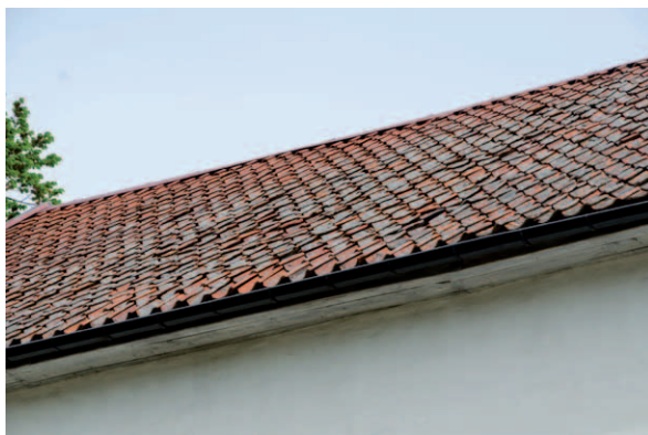
Pannorna ligger något ojämnt över takfallet. (D2015-1012)
