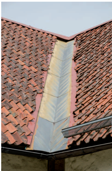
Vinkelränna där nästan all färg försvunnit. En extra plåt finns mellan tegel rännplåten. Avståndet till teglet är långt vilket gör vinkelrännorna iögonfallande. (D2015-1072)
