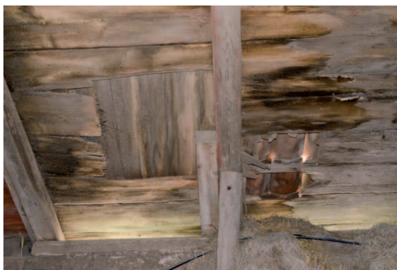
Innertaket har enstaka hål på det södra takfallet där teglet är synligt. (D2015-1050)
