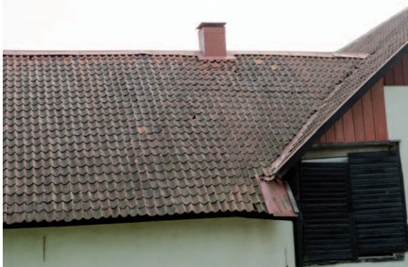
Den södra änden av det yttre takfallet. Flera pannor är skadade och bör bytas ut. (D2015-1021)
