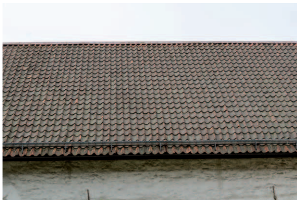
De flesta pannorna är i gott skick. (D2015-1007)
