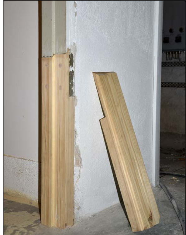
19 En av dörrkarmarna var endast rötskadad nedtill och lagades för att bevara så mycket som möjligt av originalinredningen i källaren (Slm D13-0130).
