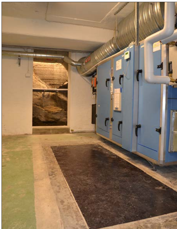
17 Samma utrymme efter avslutat arbete. Till höger i bild ses ventilationsanläggningens luftbehandlingsaggregat (Slm D13-0128).
