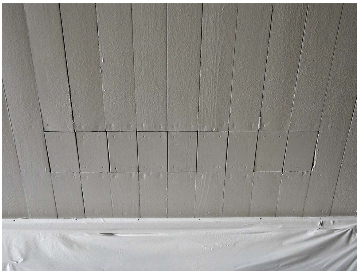
32 I anslutning till den igensatta ventilationsöppningen i ceremonirummets innertak framstår skillnaden mellan rollade och enbart penselstrukna ytor tydligt (Slm D13-0143).
