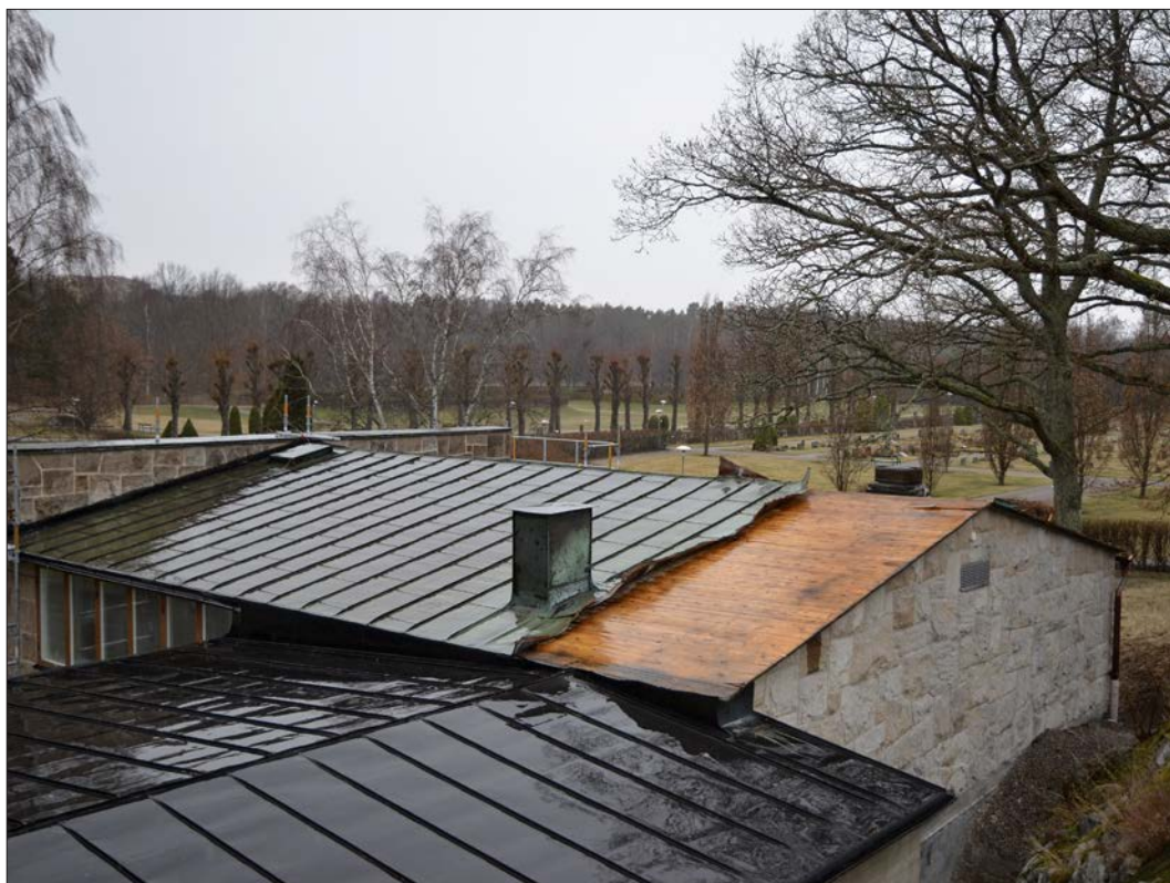
13 Kapellens södra takfall efter stölden av kopparplåt (Slm D13-0124).
