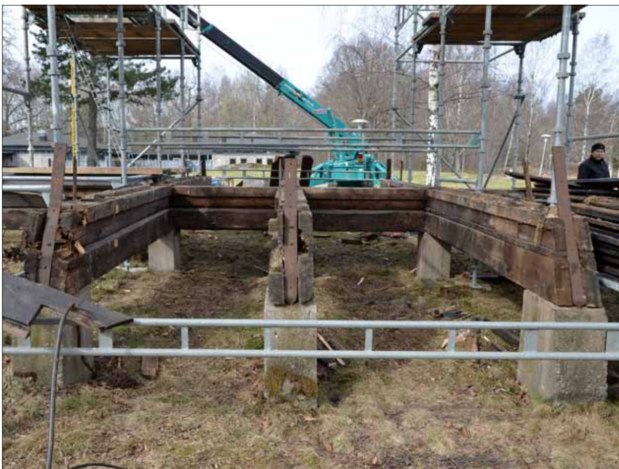
5 Klockstapeln syllar hade omfattande skador vid strävornas anslutning till syllen. Till höger i bild ses hantverkaren Jon Åhlund, Åhlunds Byggnadsvård (Slm D11-268).
