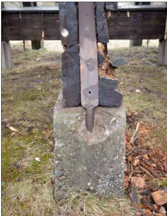
3 Rötskadat virke i syllstock och skadad betongplint (Slm D11-266).
