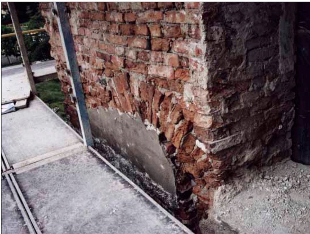
Fig 12 På tornets sydsida väster om ljudluckan finns en tegelbåge som framkom när putsytan hade tagits bort. Eftersom det finns en cementlagning nedanför bågen tyder det på att en öppning har varit synligt i ett annat tidsskede, möjligen med lägre torn.
