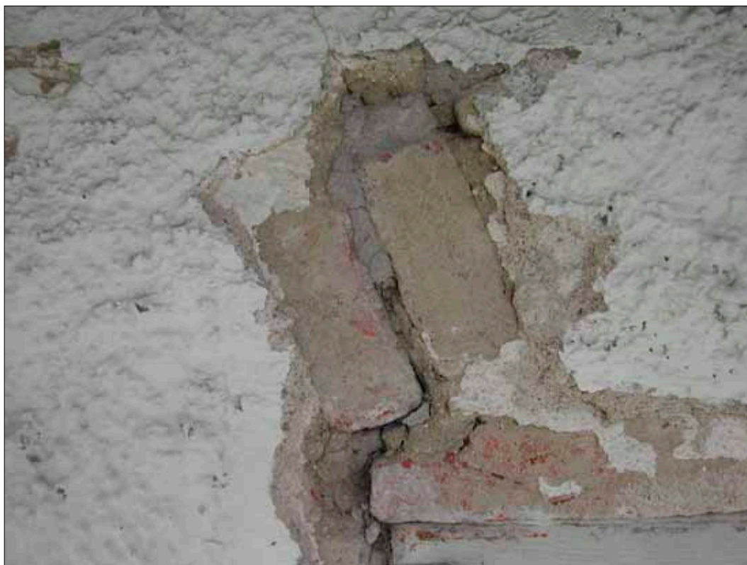
Fig 28 På korets östvägg, 1,90 m från det sydöstra hörnet, framkom en konstruktion som visar en tidigare fönsteröppning.
