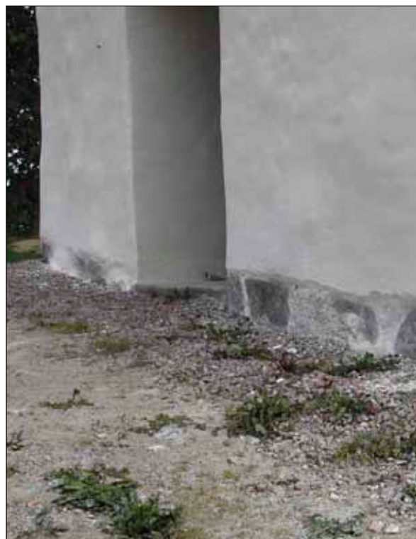
Fig 34 Fasadernas nya putsyta fick dras upp och blottlägga sockeln eftersom spjälkning uppstod efter kort tid när putsen drogs ner till marken.
