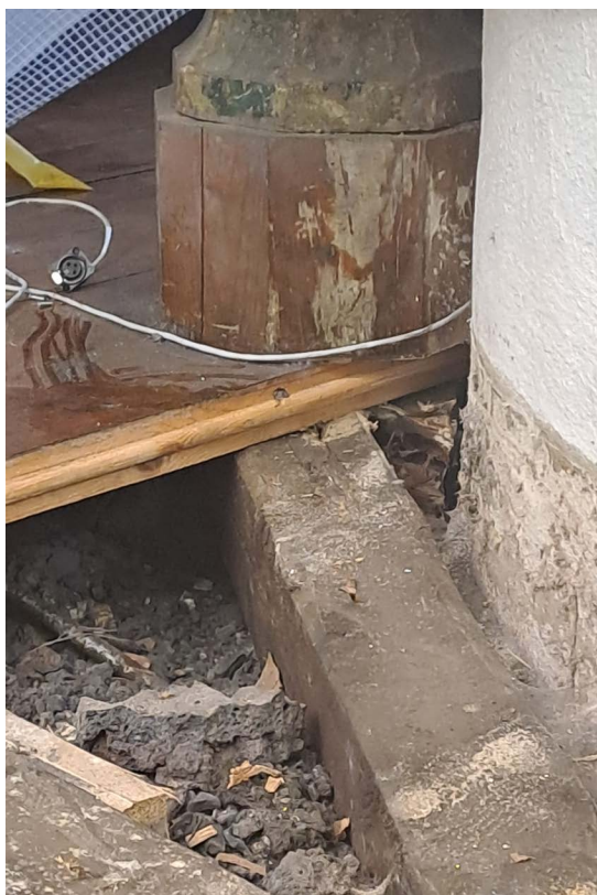
Bild 12. Röttskadat virke vid predikstolens fundament. SLM D2023-0791.
