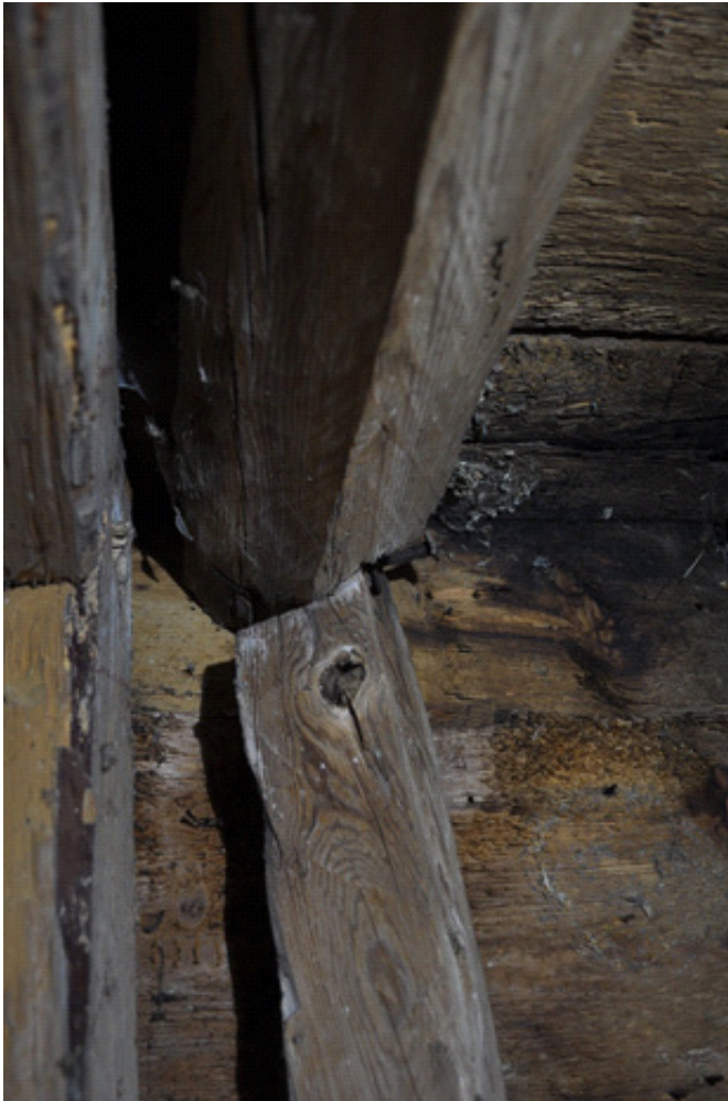
Båda högbenen i takstol 6 är kraftigt vridna. De är sammanbladade efter att vridningen uppstått. Fotografi: Daniel Eriksson
