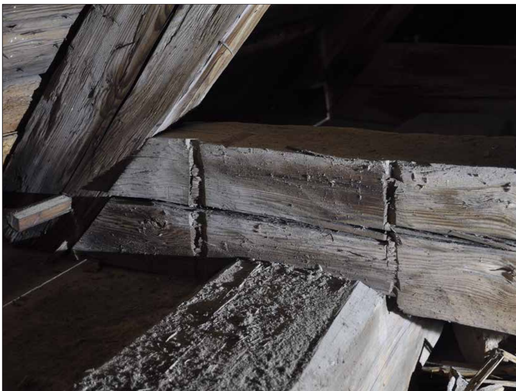
Vid grovbearbetningen av timret har timmermannen huggit för djupt (SLM D2015-1517). Foto: Daniel Eriksson.
