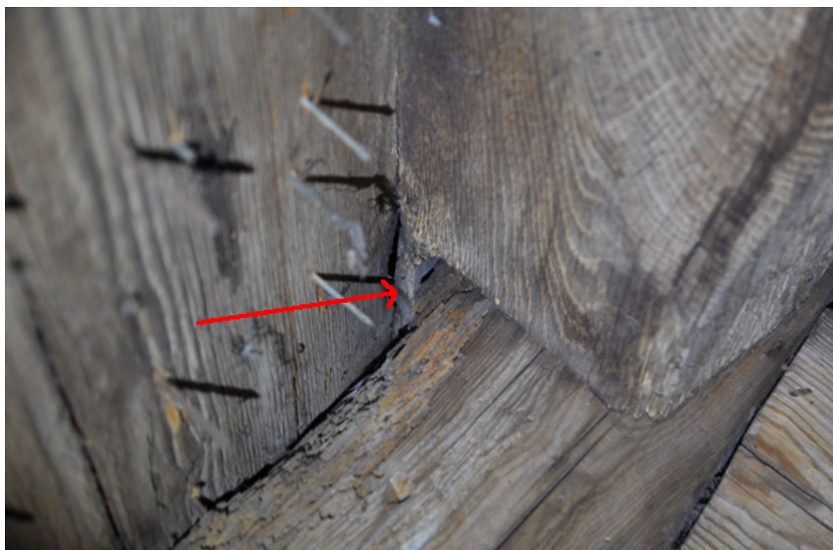
Nockåsen är kraftigt nedfälld över de tre primära takstolarna, men löper ändå hel från västgaveln till den ursprungliga östgaveln, ca 11 meter (?) i sin nuvarande längd. Oklart hur mycket som saknas i östra änden. Bilderna visar den mittre takstolen, nr12. Fotografi: Daniel Eriksson
