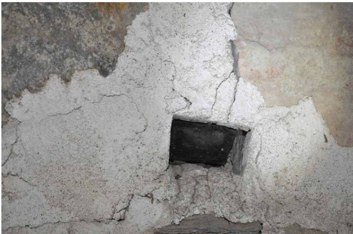
...placeringen för tvärbjälken i östra murens norra del, som också är brandskadad. Inga andra brandskador syns i taklaget för övrigt. Fotografi: Daniel Eriksson
