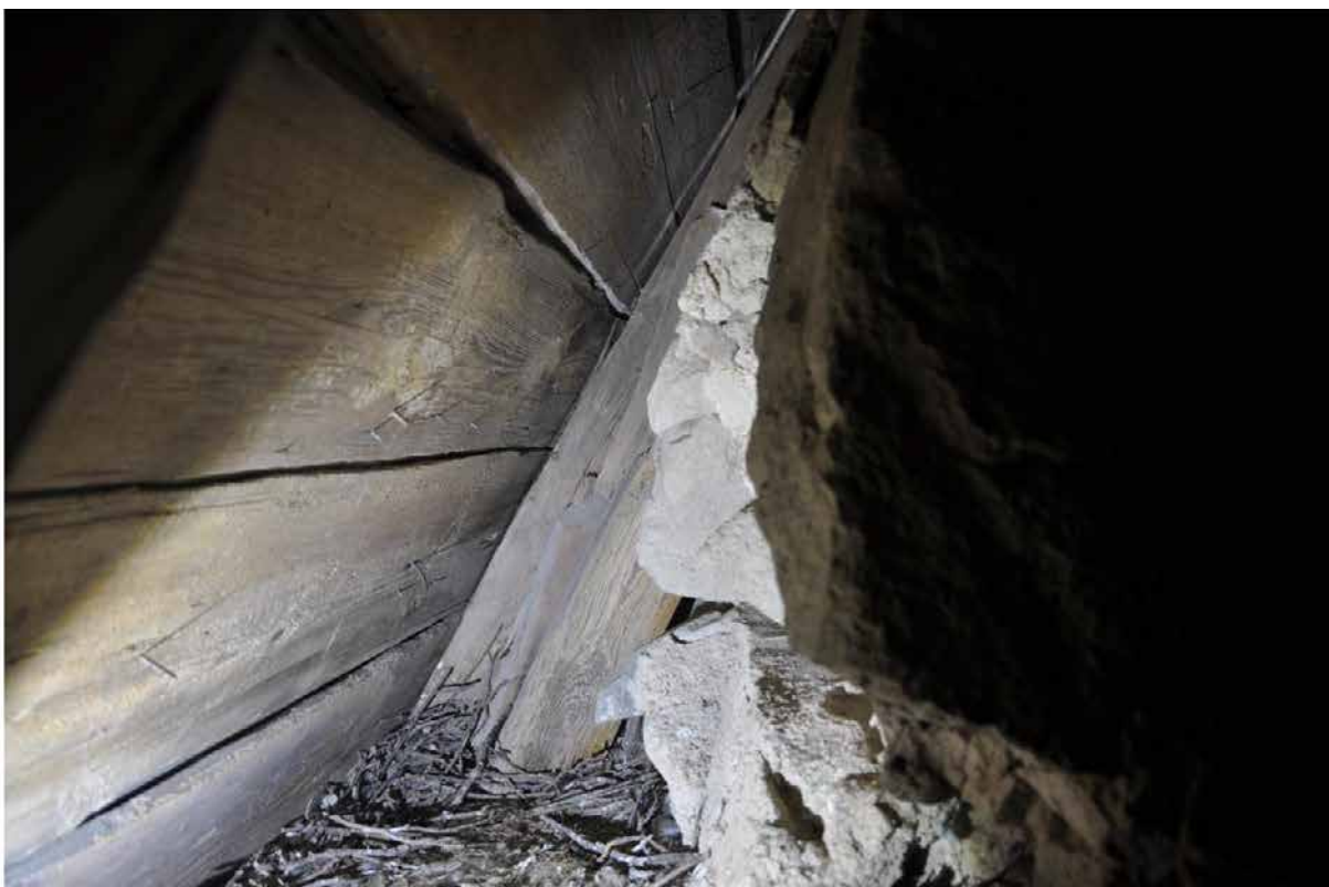
I den första takstolen i östmurens ytterliv syns ett högben som fortfarande sitter i sin ursprungliga position. Utanpå det har man lagt på en kil. Fotografi: Daniel Eriksson
