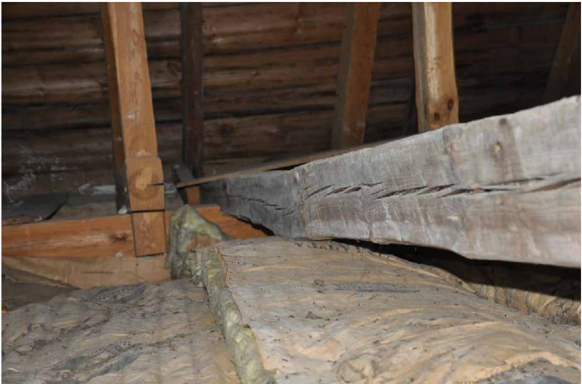
Denna bindbjälke i långhusets västra del har en krok, se märgsprickan längre bort i bild. Observera också att timmermannen har huggt virket efter denna böj, både över och undersidan. Våldigt mycket vankant finns kvar på undersidan. Det verkar märkligt om det suttit ett plant innertak i denna bindbjälke. Fotografi: Daniel Eriksson
