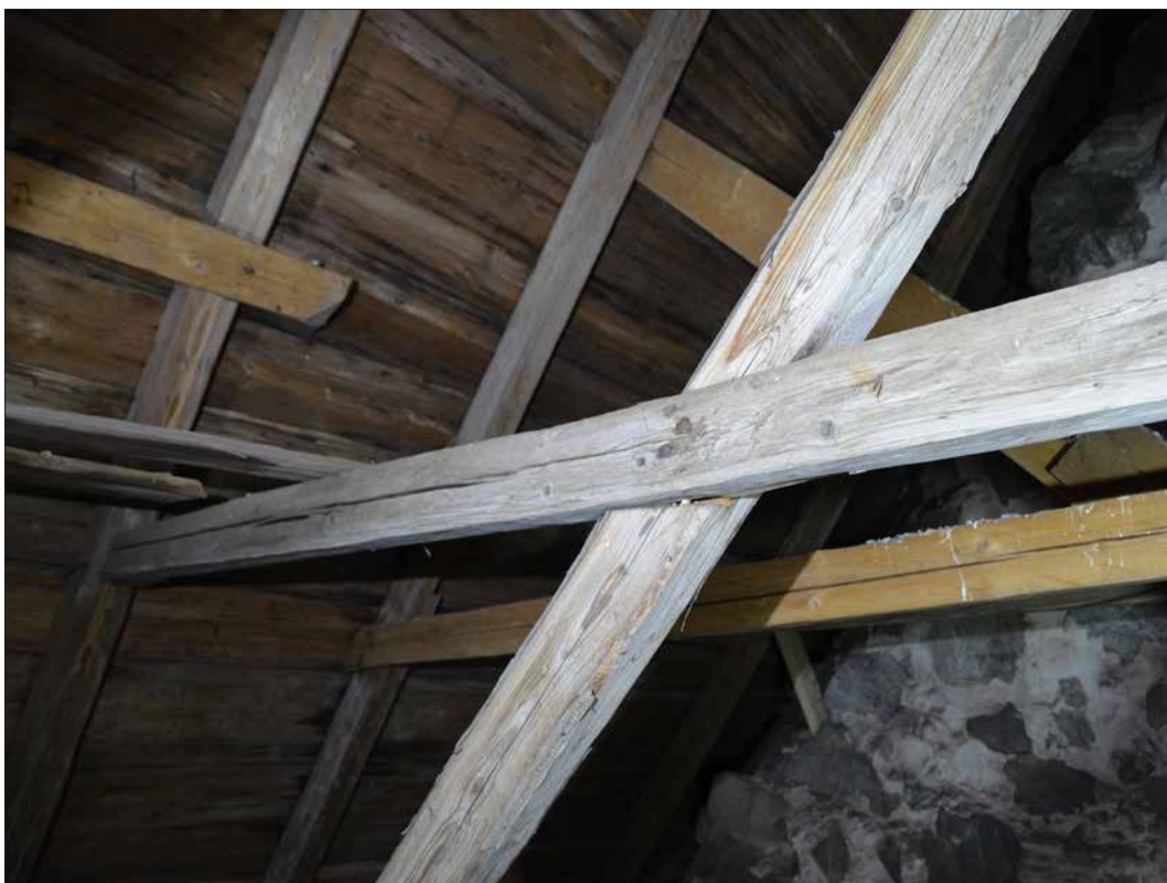
Hela takkonstruktionen har i östra delen vält kraftigt mot öster varför hela konstruktionen i sen tid förstärkts med påspikade regler och plank (SLM D2015-1393).
