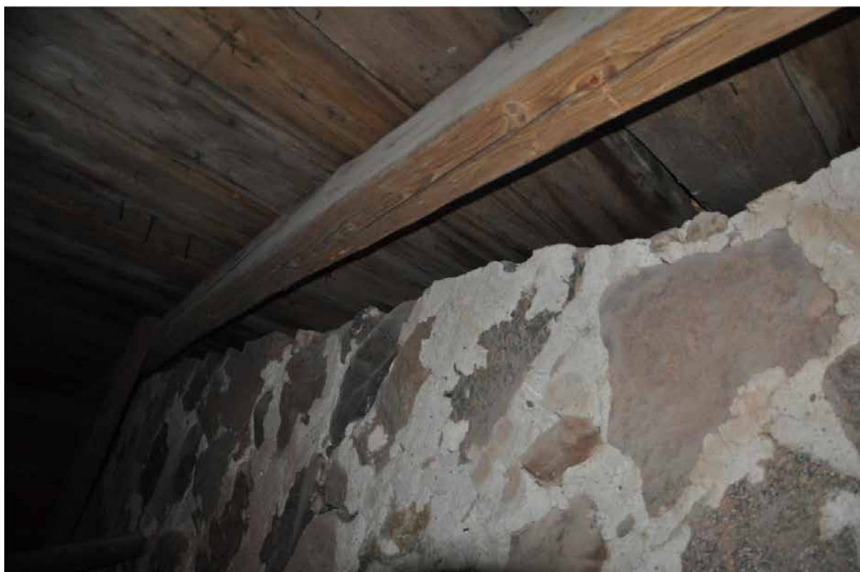
I östra gaveln ser man att det nedtill finns ett mellanrum mellan muren och taktron. Detta mellanrum smalnar av uppåt. Fotografi: Daniel Eriksson
