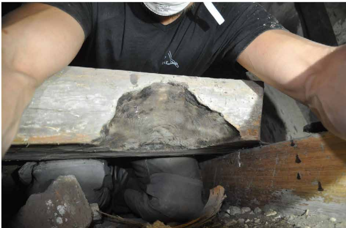
Bindbjälken som suttit intill östra muren har en begränsad men kraftig brandskada. Brandskadans placering stämmer överens med....
