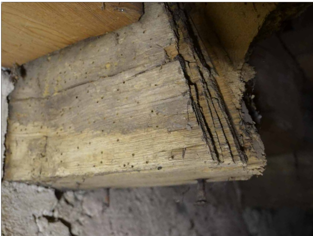
Avkapad bindbjälke med smidd spik från äldre plant innertak (SLM D2015-1421).
