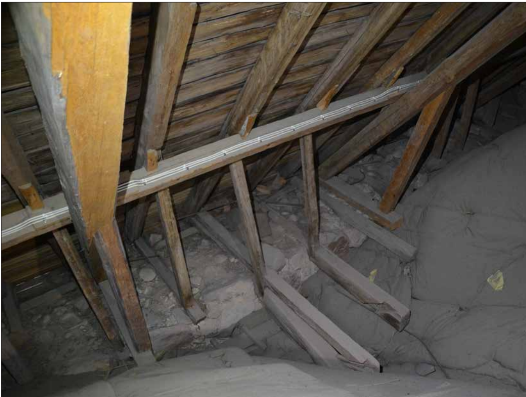
Avkapade bindbjälkar på norra sidan av långhusvinden (SLM D2015-1475).
