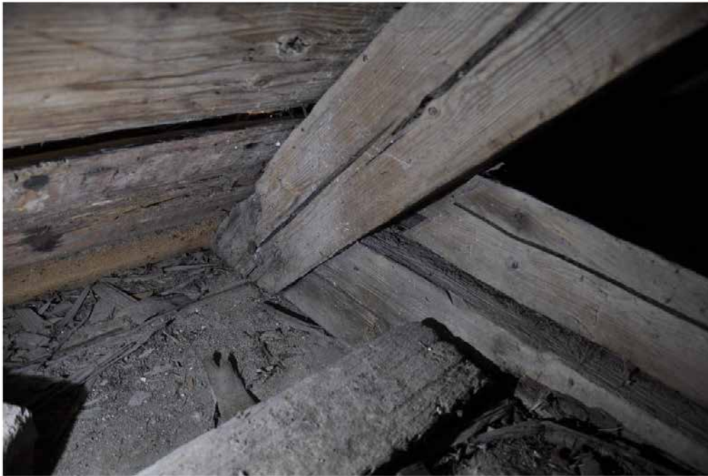
Ursprungligt högben och bindbjälke, likaså remstycket i ek. Knutpunkten är ursprungligen dymlad. De tre spikarna är troligen sekundära. Bladning halvt-i-halvt. Fotografi: Daniel Eriksson
