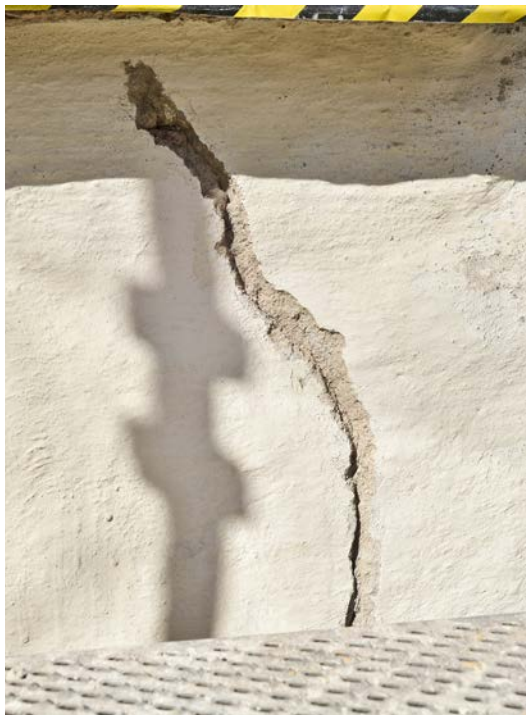
Bild 18. Sprickor och bortfallen puts höggs upp till fast yta...
