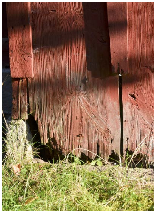
Bild 22. Rötskadat ändträ på entréutbyggnaden. SLM D2021-0485.
