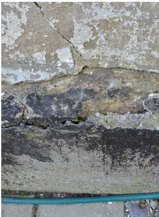
Bild 21. Sprucken och frostsprängd cementputs på sockeln. SLM D2021-0484.
