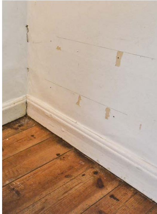
Bild 28. Cafél lokalen, rum 105. Golvbrädorna och sockeln bör bevaras. Våggarna är slitna och kan renoveras med nya ytskikt. SLM D2021-0491.
