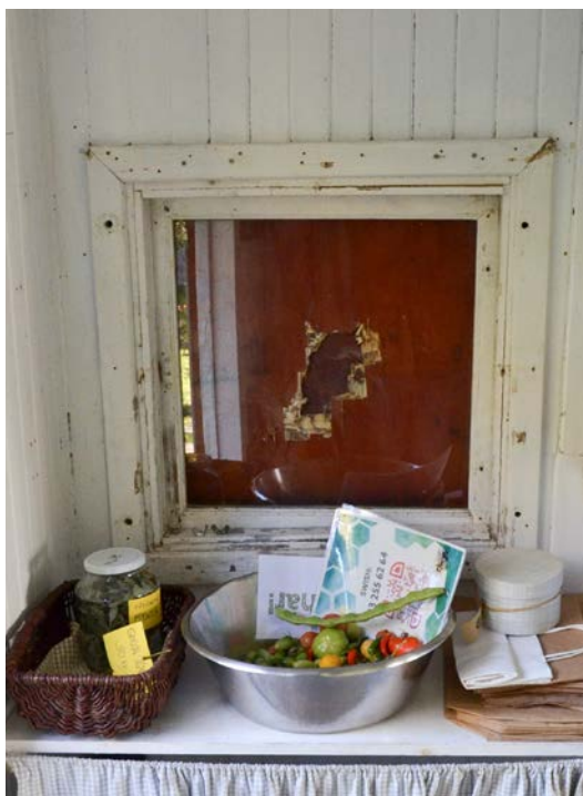
Bild 23. Förstugans (rum 101) ospröjsade fönster och foder av funkisstil är mycket slitna och passar stilmässigt inte med byggnadens i övrigt äldre karaktär. SLM D2021-0486.
