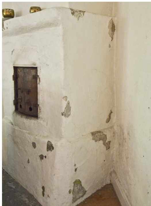
Bild 30. Cafél lokalen, rum 105. Rörspisen har bompartier och sprickor i putsen, och bör renoveras genom putslagning och avfärgning. SLM D2021-0493.
