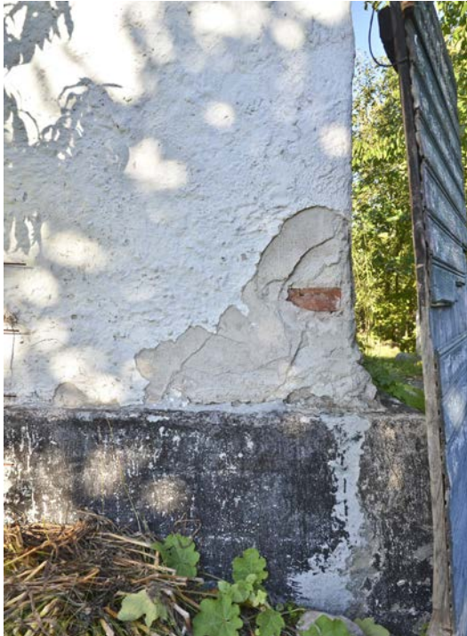
Bild 19. Putsskador på sockel och fasad. SLM D2021-0482.
