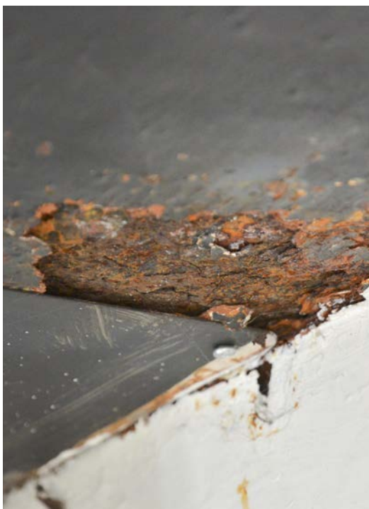
Bild 26. Kök, rum 104. Rostskador i plåten ovanför spishällen. SLM D2021-0489.
