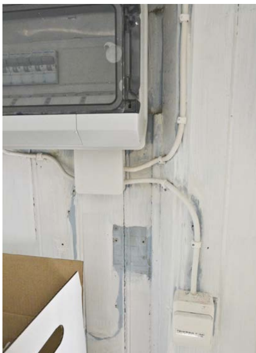
Bild 24. Passagen (rum 102). Elkablar och strömbrytare är små detaljer som har stor betydelse för inredningens karaktär. Panelen är slarvigt målad och bör åtgärdas. SLM D2021-0487.
