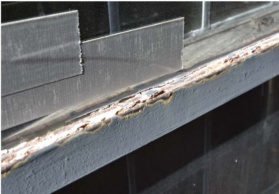
Bild 7. Vänstra balkongdörren, med provisoriskt åtgärdade sprickor i fönsterglasets samt rostskador i tvärpostens överdel. SLM D2020-0524.
