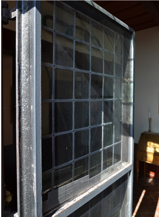
Bild 8. Den vänstra balkongdörren av gjutjärn (vy in mot rummet från balkongen). Dörrarna har tyvärr slängts. SLM D2020-0525.
