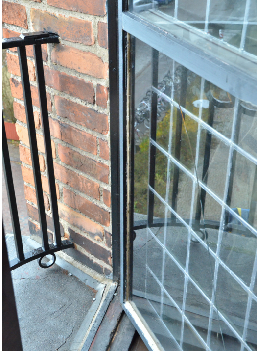
Bild 5. Den högra balkongdörren med sprucken nedre ytterruta. SLM D2020-0522.
