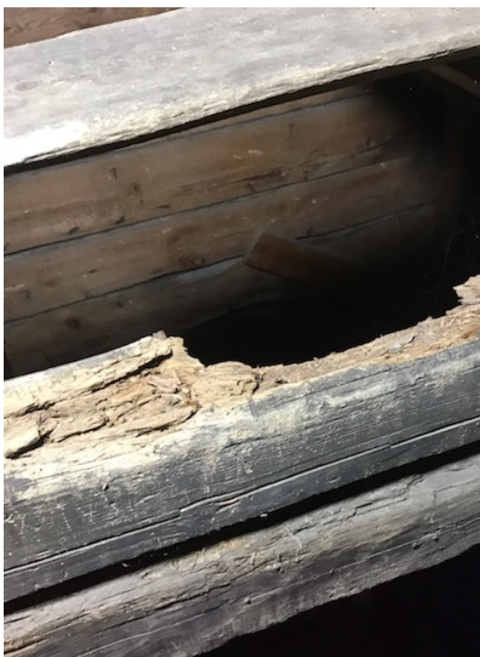
Bild 9. Den rötskadade timmerbjälken strax under takluckan. Foto: Andreas Bure, våren 2019.
