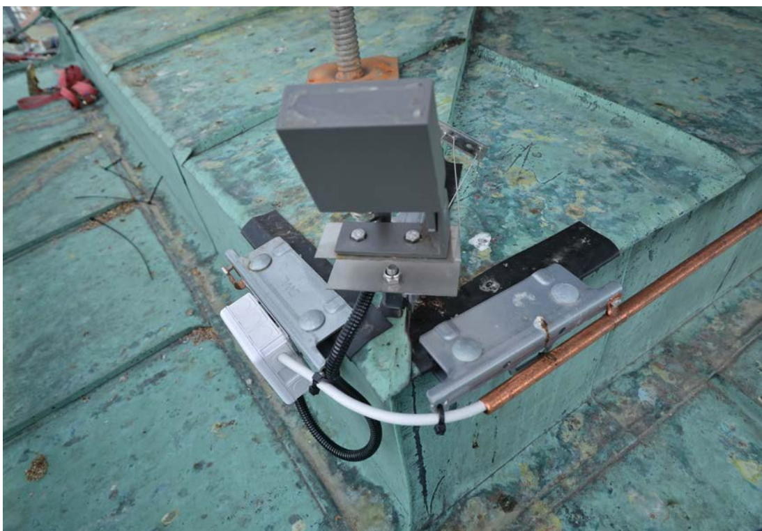
Bild 42. Ny armatur och ny rörledning i koppar för elkabel. Foto: 2019-07-08. SLM D2020-0148.
