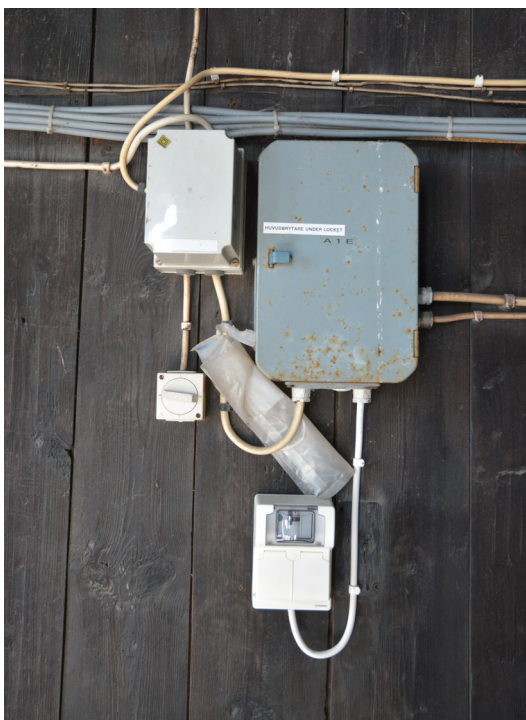
Bild 27. Ny proppdosa med kontaktuttag på väggen i kyrktornets lanternin. Foto: 2019-07-12. SLM D2020-0133.
