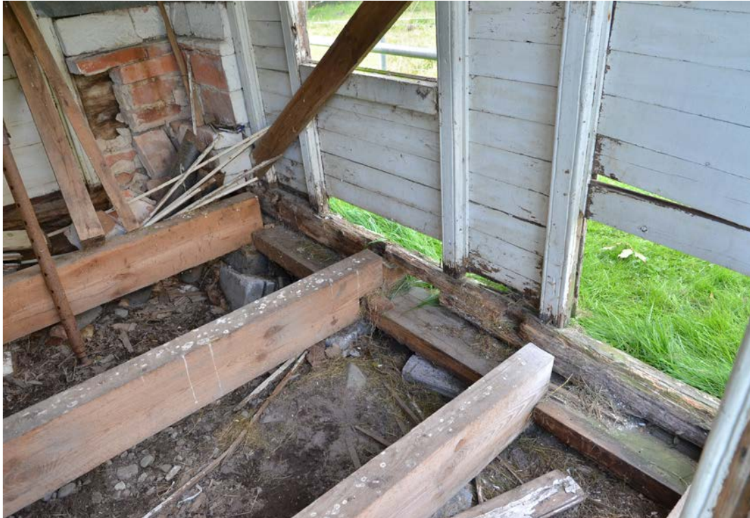
5 Den ursprungliga syllramen var svårt rötskadad. En senare kompletterande syllram hade monterats under originalsyllarna. Golvbjälkarna var monterade i kompletteringssyllen, norra långsidan (SLM D2020-0793).
