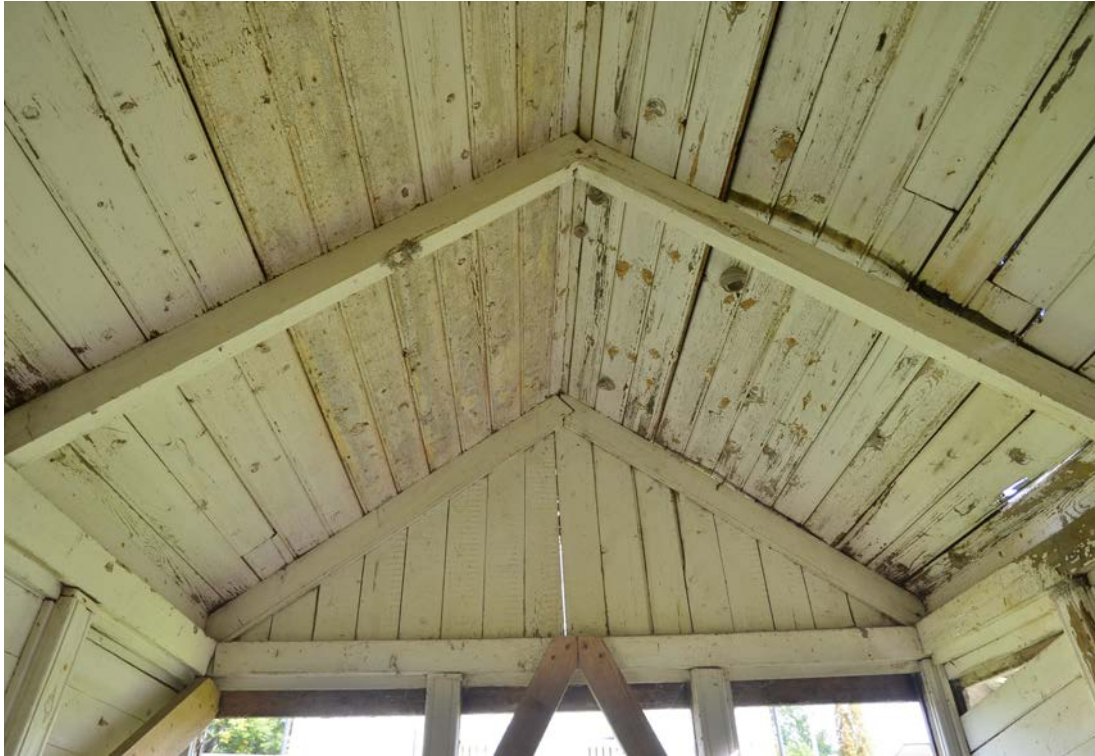
7 Innertaket var i dåligt skick och fick bytas, vy mot öster före flytten (SLM D2020-0795).
