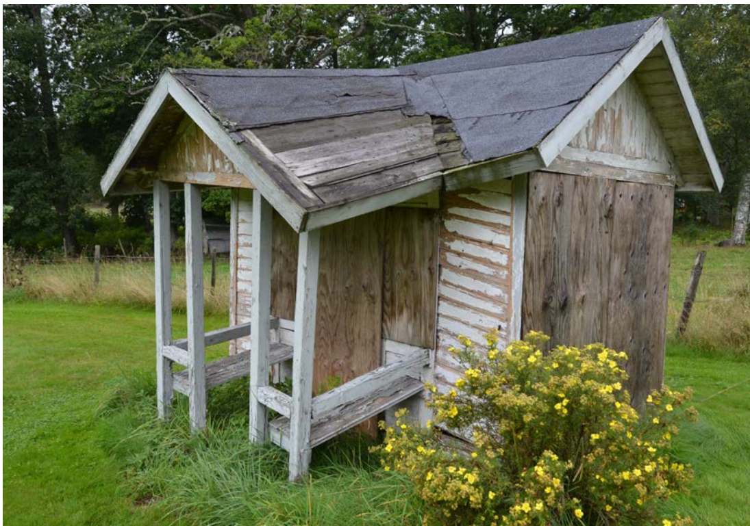
17 Lekstugan från sydost då arbeten påbörjades i september 2019. Farstukvisten har satt sig. (SLM D2020-0803).
