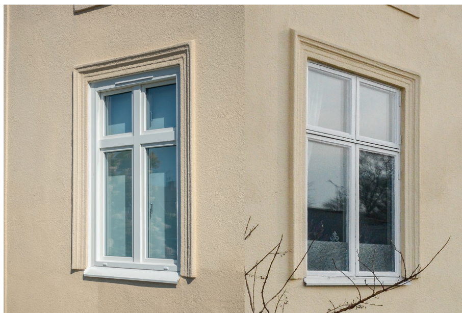
En jämförelse mellan ett nytt och ett gammalt fönster på Brandstoden 16. Skillnaden är enorm där bäge och karm är oerhört klumpiga och grova på det nya fönstret. Som ett resultat av detta har de nya fönstren betydligt mindre glasyta än de äldre, och därmed sämre ljusinsläpp i lägenheterna. Är ändringen varsam? Foto: David Hansson (SLM D2019-0402)
