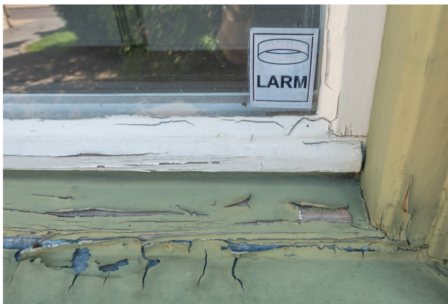
Närbild av ett av fönstren mot Östra Kyrkogatan. Färgen har flaggat, dock i första hand på karm och fönsterbleck. Fönster från denna tid tillverkades ännu med kådrikt kärnvirke varför träet trots eftersatt underhåll oftast är i gott skick. Foto: David Hansson (SLM D2019-0400)
