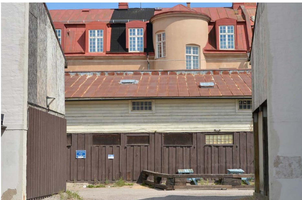
Den östra längan sett genom den infart som skapades 2007 då en del av den västra längan revs. Plåttaket på den östra längan är nästan i sin helhet täckt av ytrost. På grund av läckage har takfönstren täckts över med plast. I bakgrunden syns Järnhandlaren 23 och 24. (SLM D2018-0608)
