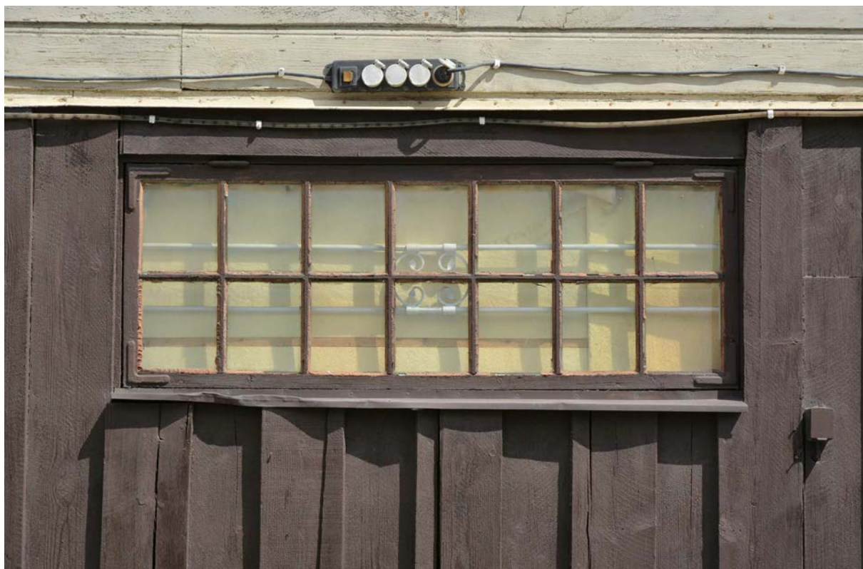
Ett av de högt sittande ursprungliga fönstren på den östra längan. Den bruna panelen har satts över den ursprungliga i senare tid. Dessa kan, om planlösningen tillåter det, med fördel bevaras vid en ombyggnad. (SLM D2018-0603)
