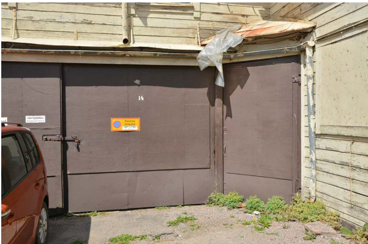
En av portarna som är upphängda i skenor upptill. Portarna har på senare år satts över med plywoodskivor. Under dem finns de ursprungliga portarna kvar vilka är välbyggda dörrar med ramverk och fyllningar av trä. (SLM D2018-0606)
