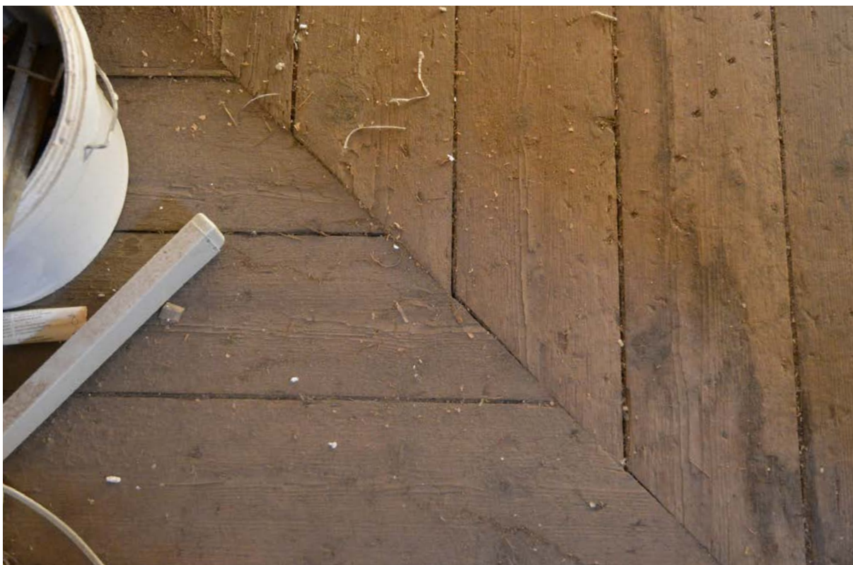
Brädgolvet som ligger på den övre våningen i östra och norra längan. Golvet skulle i renoverat skick ge ett mervärde åt nya lägenheter. (SLM D2018-0600)
