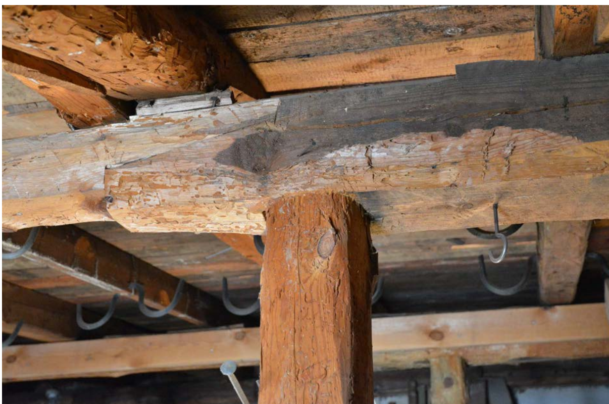
Virke med äldre spår av insektsangrepp. Innanför ytan är virket friskt med god bärighet. Byggnaden bör vid en ombyggnad undersökas av skadebekämpningsföretag för att utreda om det finns några aktiva skadedjur. (SLM D2018-0601)
