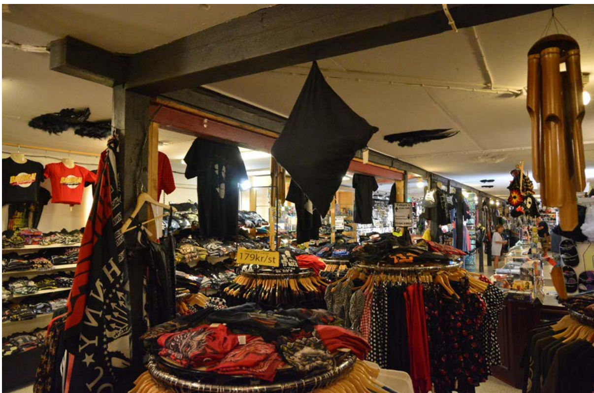
Bild av butiksinteriören i den östra längan sett från norr. Den bärande stommen som är synlig har här förstärkts med stående plank och en liggande I-balk. (SLM D2018-0607)
