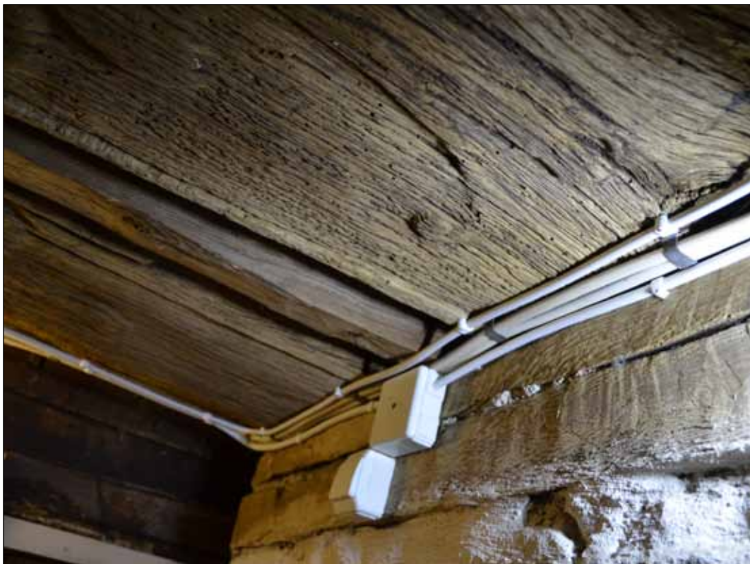
80 Okänsligt dragna elinstallationer (SLM D2015-1415).
