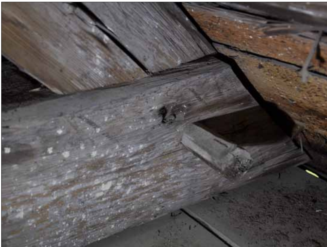
245 Snett ovanför dymlingen syns två grunda borrhål som går i varandra. Troligen har de uppstått då takstolen använts som mall. Malltakstolen har legat på marken och övriga har tillverkats ovanpå. Vid borrning har man råkat borra in i "mallen" (SLM D2015-1516). Daniel Eriksson.
