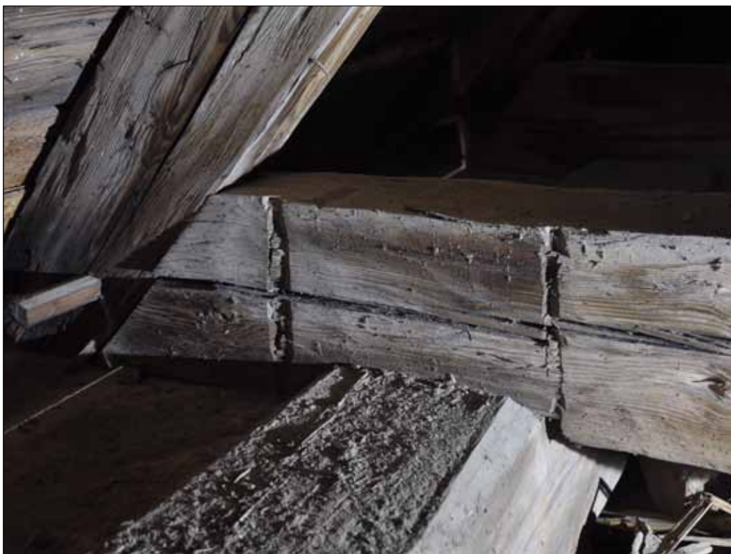
246 Vid grovbearbetningen av timret har timmermannen huggit för djupt (SLM D2015-1517). Foto: Daniel Eriksson.
