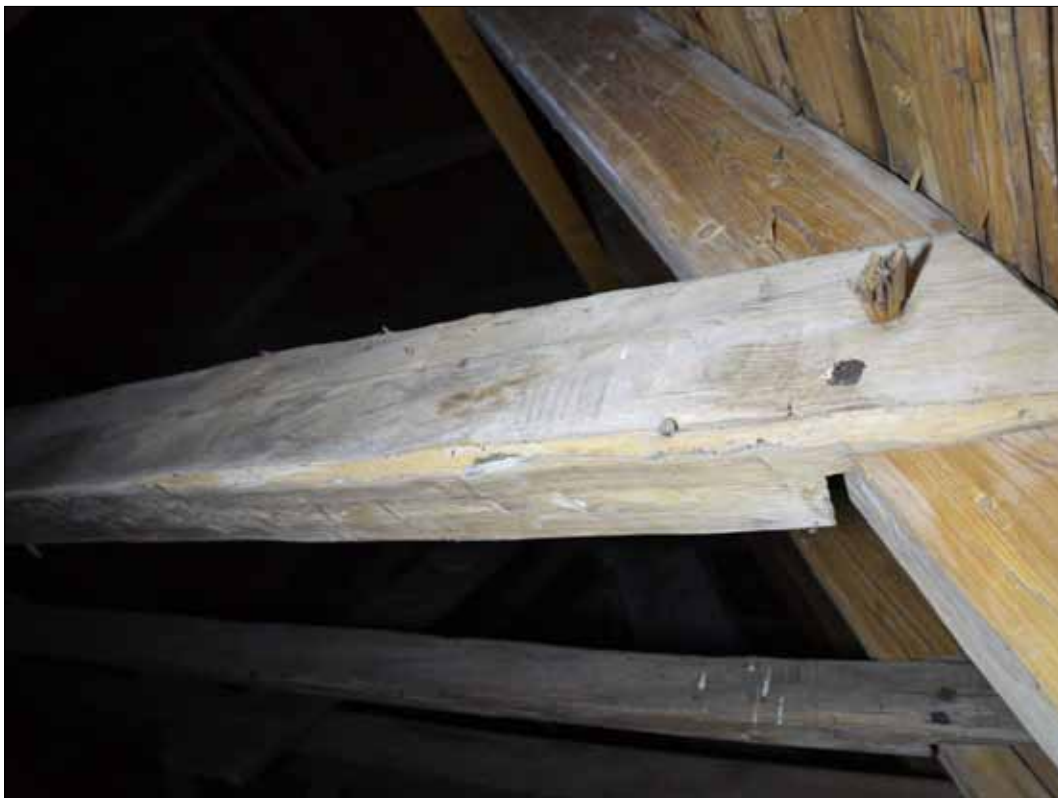
62 Hela takkonstruktionen har i östra delen vält kraftigt mot öster varför hela konstruktionen i sen tid förstärkts med påspikade regler och plank (SLM D2015-1403).
