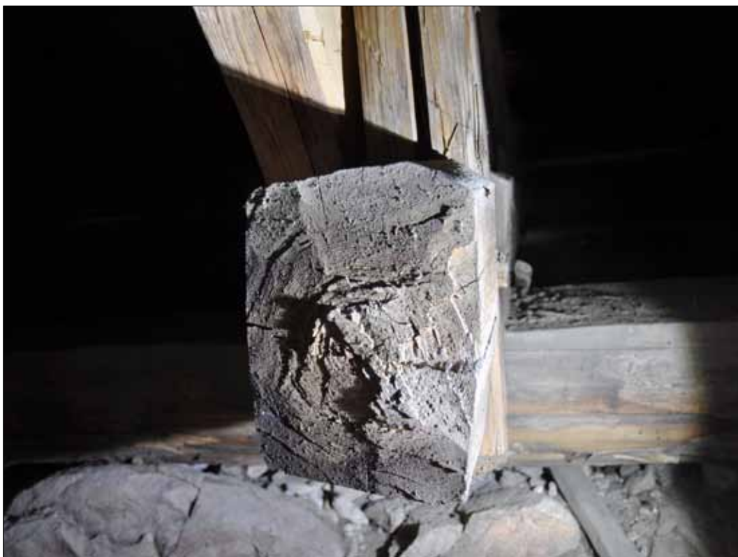
242 Änden på en tass som kapats med yxa innan montering vilket syns eftersom huggen kommer från alla fyra sidor, även underifrån där man inte kommer ut att hugga i befintligt läge. Tassarna är alltså inte ursprungliga bindbjälkar som kapats (SLM D2015-1513). Foto: Daniel Eriksson
