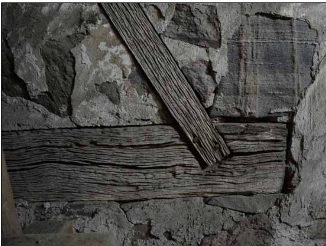
122 Långhusets västra gavelröste som före 1600-talets tillbyggnad mot väster var synligt. I gavelröstet finns en inmurad takstol som bör vara 1200-tal. Takstolsvirket är väderbitet och stödbenen är spikade med smidd spik. (SLM D2015-1440).
