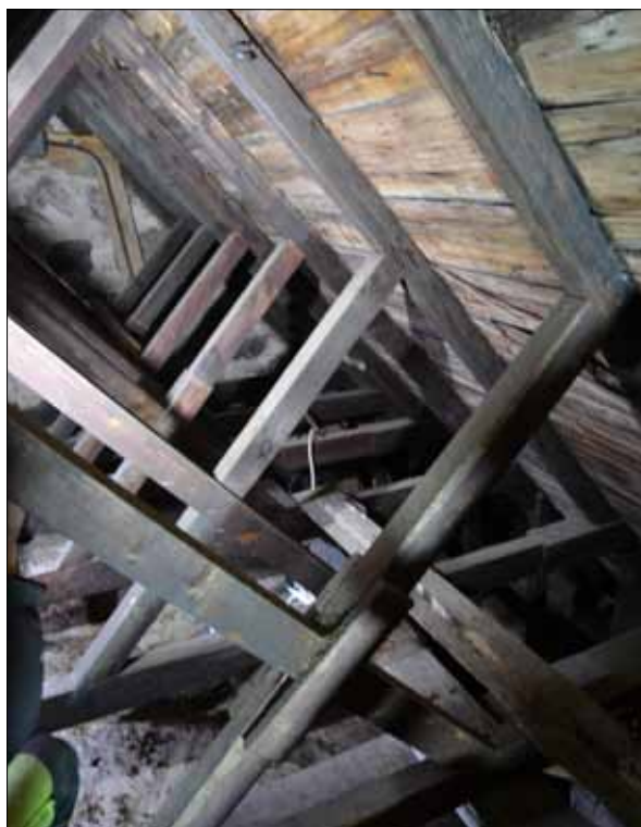
119 Takstolarna över långhuset är renoverade år 1953. Takstolarna har dock en romansk utformning (SLM D2015-1437). Fotograf Eva Wockatz.
