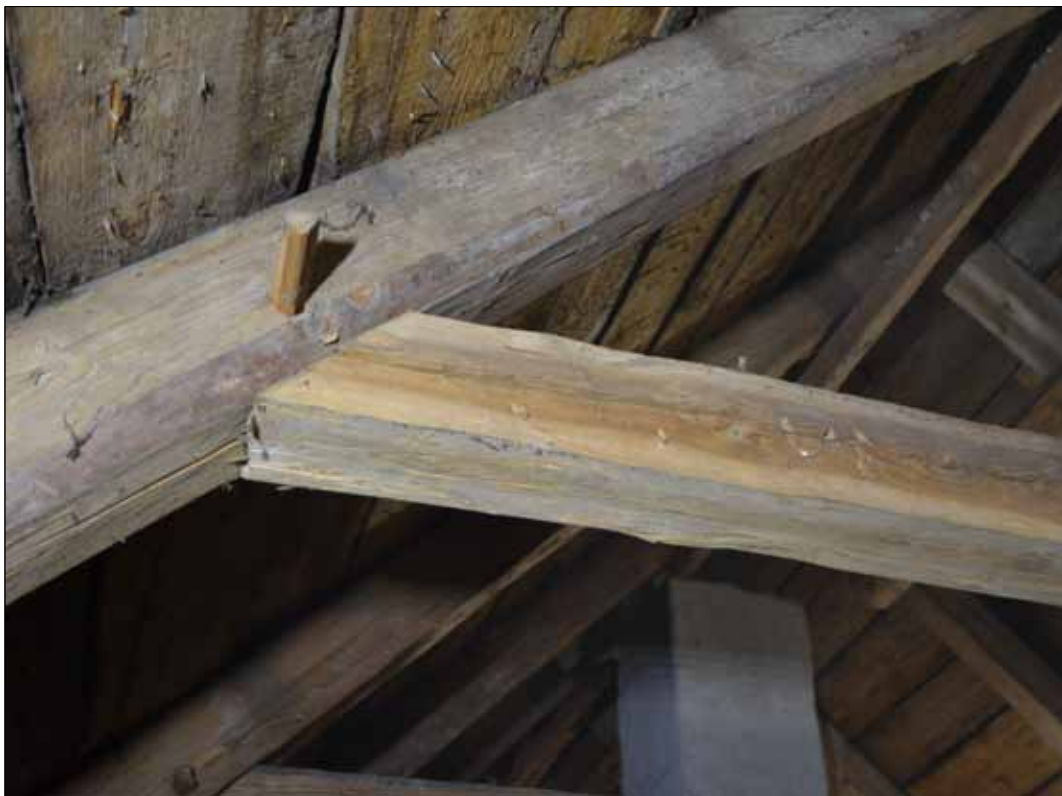
84 Timmermansmärkning i form av flaggor i mötet mellan högben och hanbjälke (SLM D2015-1419).
