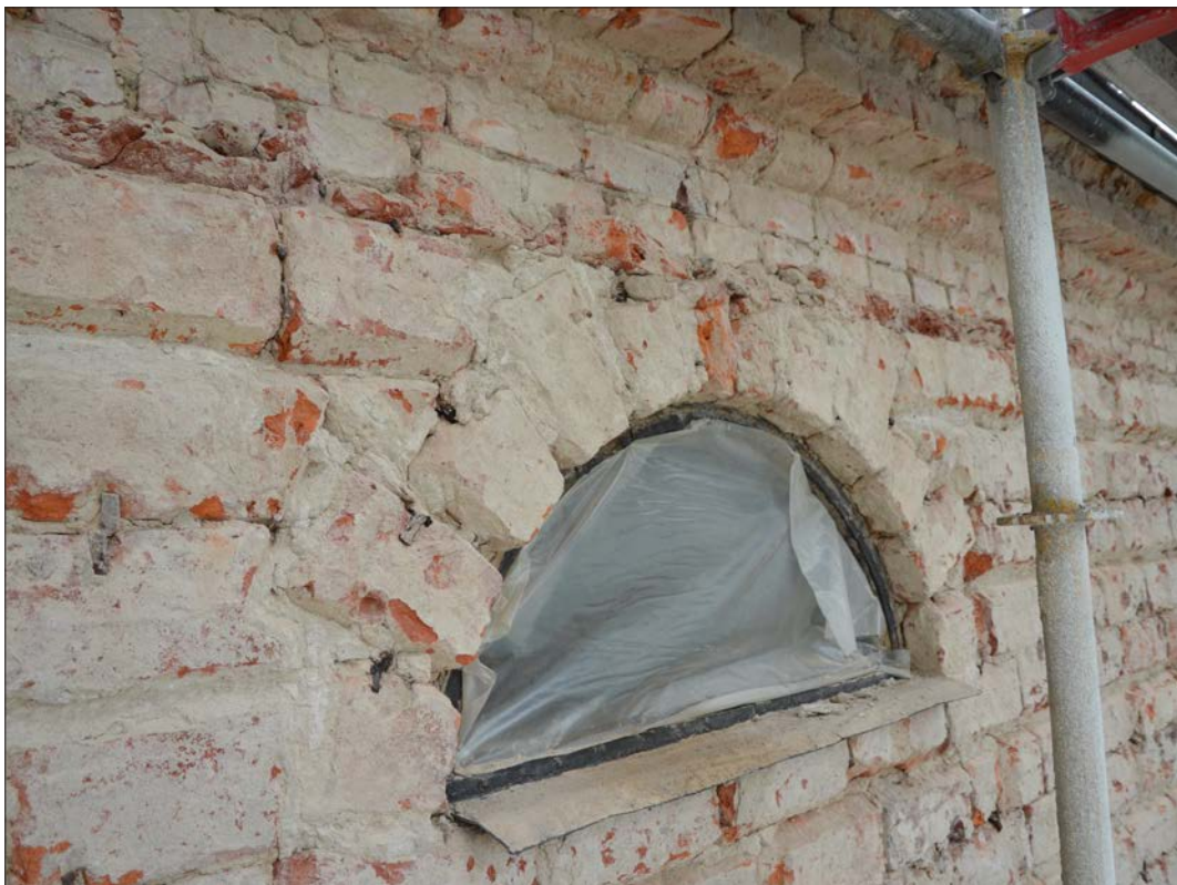
8 Södra fasadens rusticering. På södra fasaden "klippte" fasadens toruslist av fönstervalvet (Slm D2013-860).
