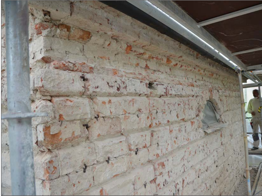
7 På norra fasaden slutade toruslisten innan den nådde fönstervalvet (Slm D2013-859).
