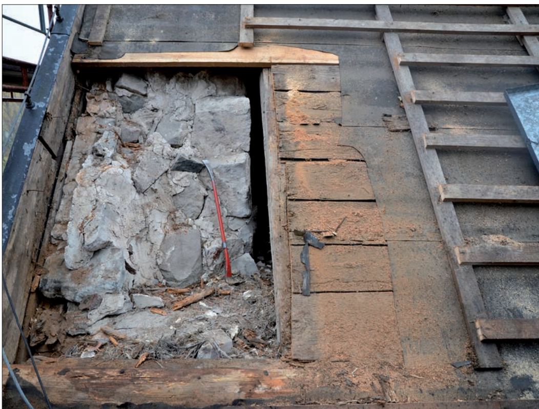
10 På det norra takfallet fanns en mindre rötskada på underlagstaket (Slm D12-0792).
