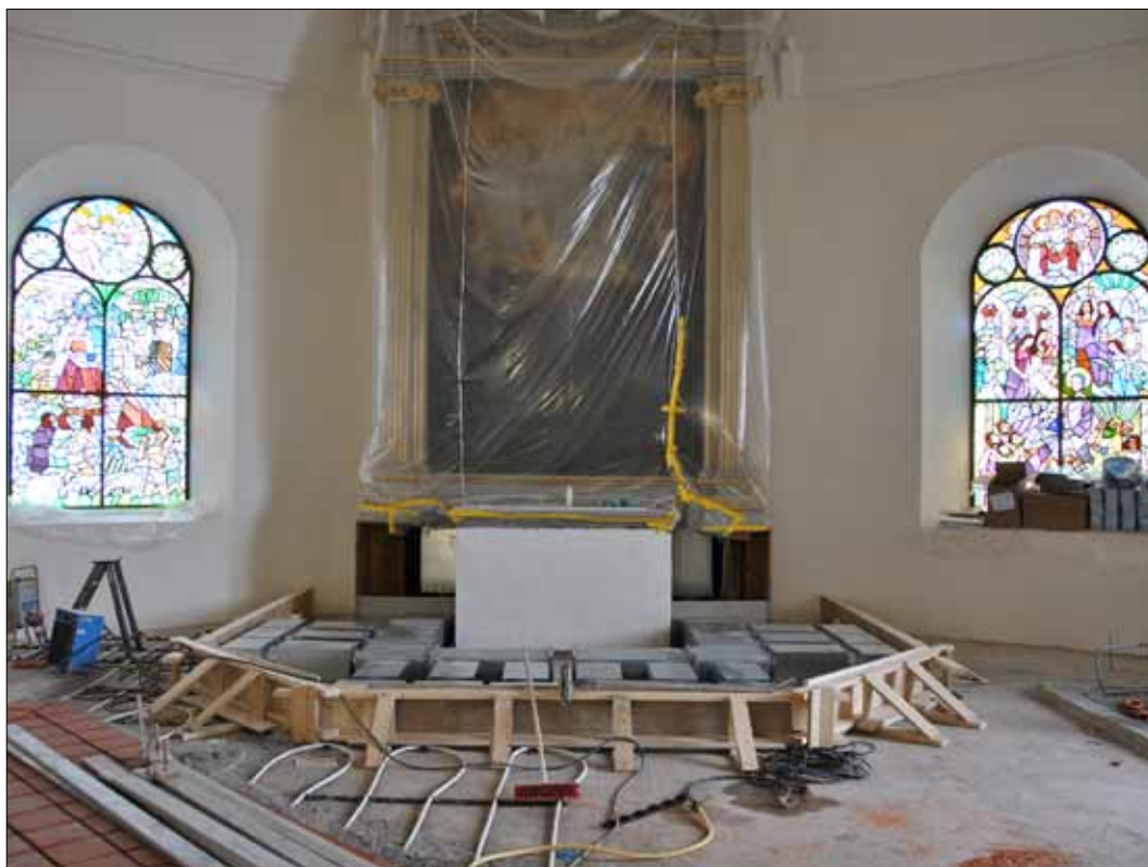
28 Altarringen döljer omfattande tekniska installationer (Slm D11-429).
