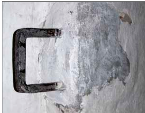
20 Infästningen för låsbygelns vid sakristian lagades med ett cementhaltigt bruk efter ett inbrott i mitten av 1980-talet, 20080611 (Slm D09-102).
