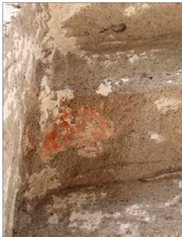
26 Äldre färgskikt bevarade på väderskyddad plats i det västra blindfönstret på kyrkans södra fasad, 20080616 (Slm D09-104).
