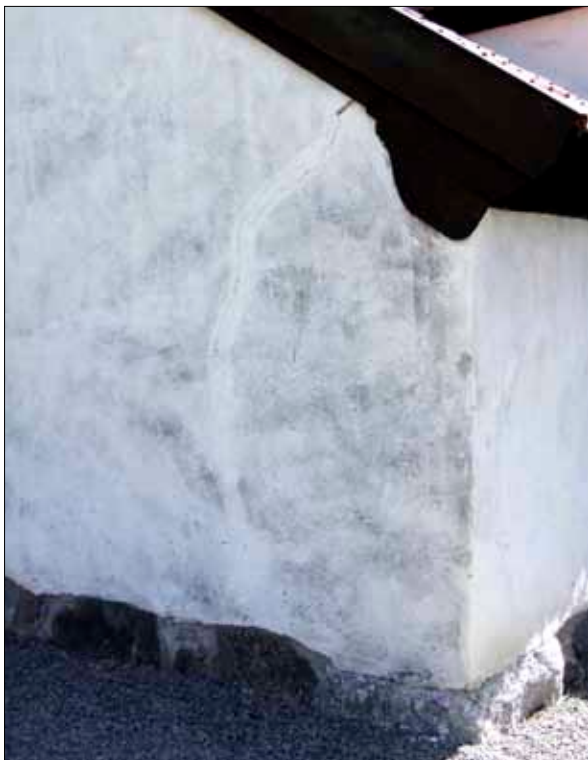
10 Spricka vid sakristians nordvästra hörn. Fotografiet är taget från norr, 20080508 (Slm D09-097).
