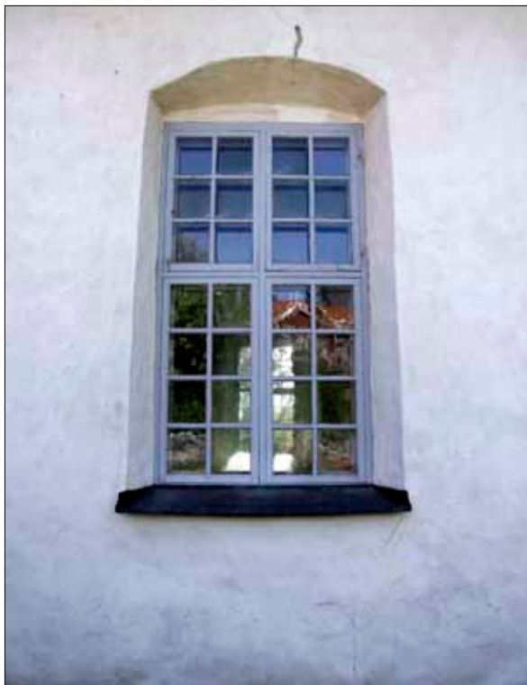
11 Rörelsesprickor i anslutning till fönstret i långhusets norra fasad. Fotografiet är taget från norr, 20080508 (Slm D09-096).
