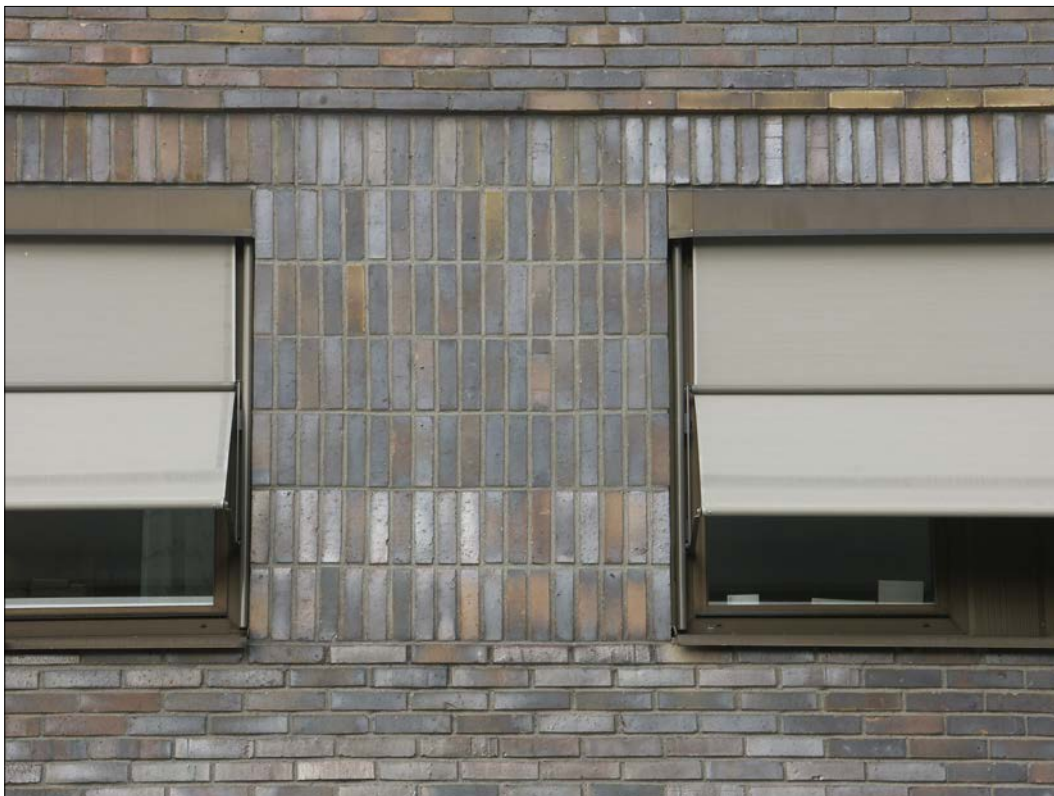
Fig 22 Mönstermurning är en särskild accent i fasaden. Här syns tydligt hur markismonteringen och solskyddet förändrar arkitekturen både på detaljnivå. Med så många fönster blir uttrycket påtagligt.
