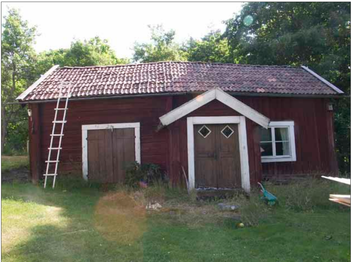
4 Östra flygeln i juni 2008. Taket svackar och flera syllstockar är rötskadade.
