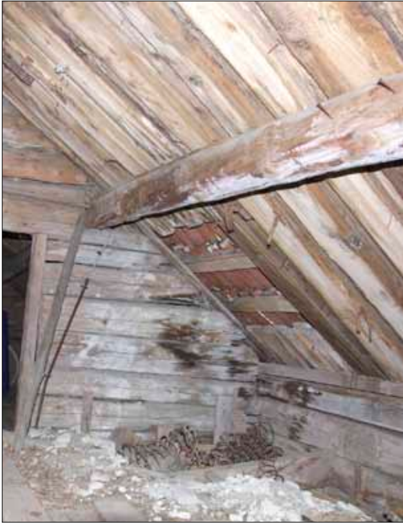
8 Undertaket i östra flygeln, vid östra sidoåsen, där takläckage hade förekommit.
