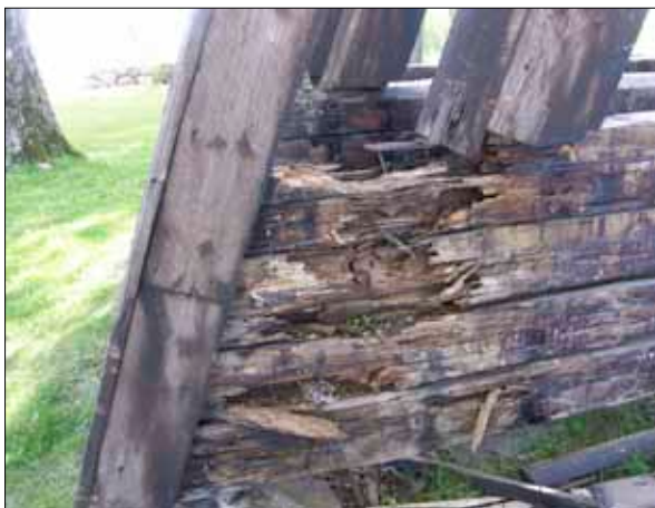
8 Ö3 före renoveringen. Rötskadorna var relativt omfattande.
