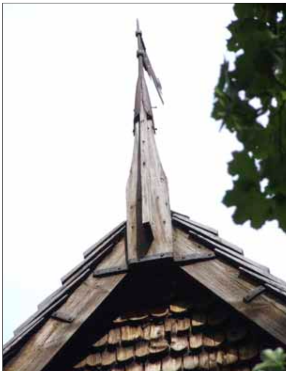
9 Flöjeln på taknocken före åtgärder.
