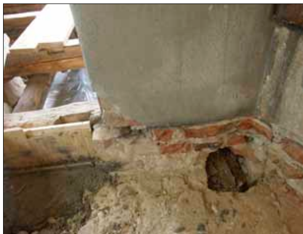
16 Rundstocken i bjälklaget var kraftigt rötskadad. Rum 15 sydvästra hörnet.
