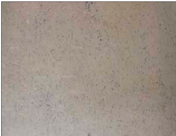
9 Stänkmålning i rum 11 på östra väggen.
