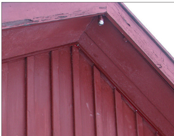
12 Vid de båda vapenhusen doldes värmekabeln bakom en trälist som målades in.
