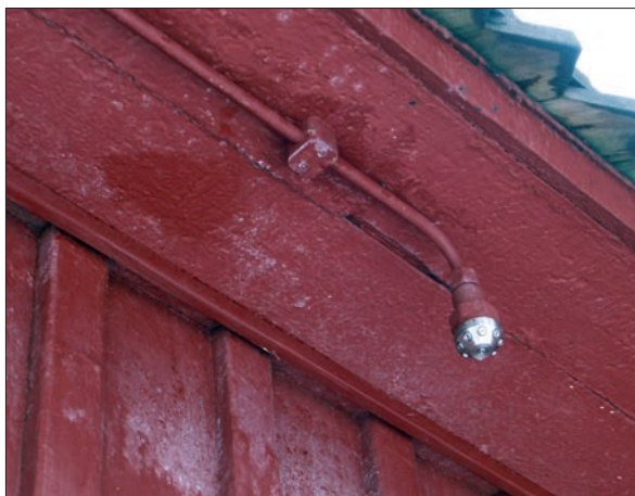
10 Sprinklermunstycke monterat på fasaderna, under takfoten. Rören har målats in i fasadens rödfärgade kulör.
