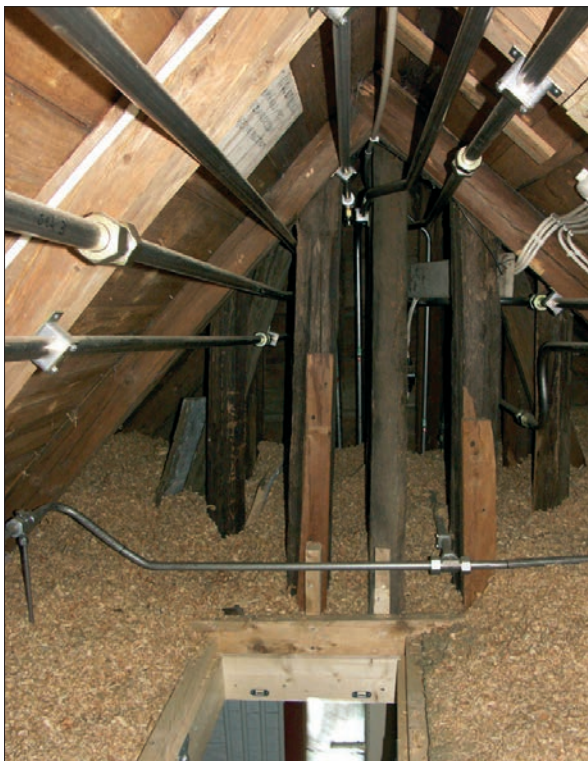
34 Rörinstallationer på vind, som går in mellan spirans konstruktionsdelar.
