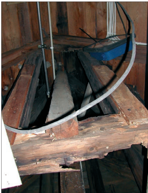
28 Rötskadad bjälke under spiran innan arbeten påbörjades. Bjälken lagades provisoriskt innan rörinstallationer monterades.
