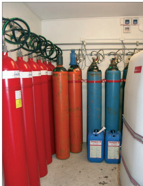
14 Interiör av pumphuset. Gasflaskor till vänster och vattentanken till höger.
