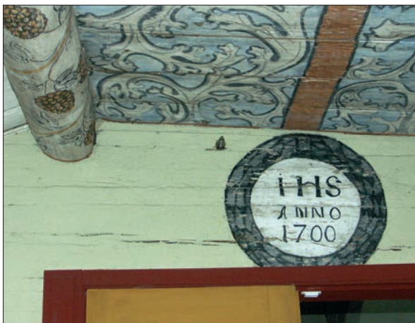
9 Detalj av sprinklerhuvud i västra vapenhuset.
