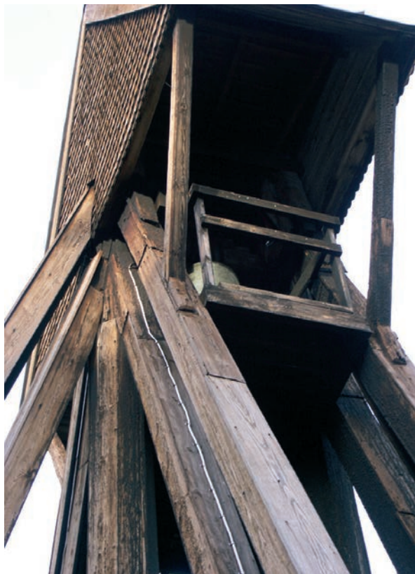
Bild 17. Till vänster: Huven före åtgärder, klädd med senare spåntäckning.
